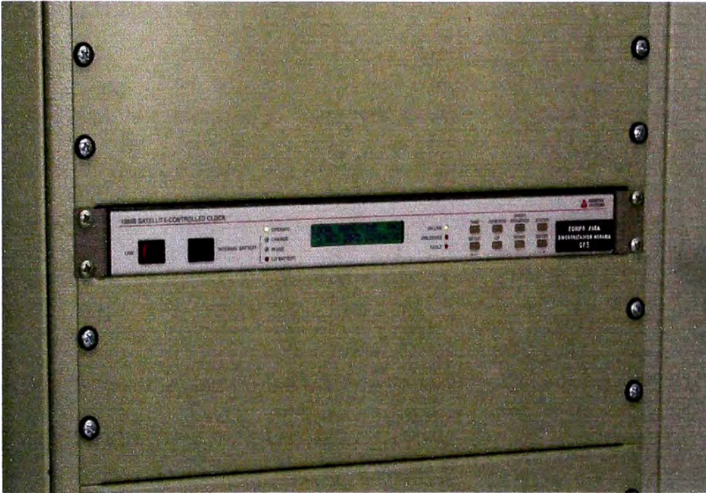
Foto N° 8.1 Relog GPS 1088B en Gabinete de sala de Control
