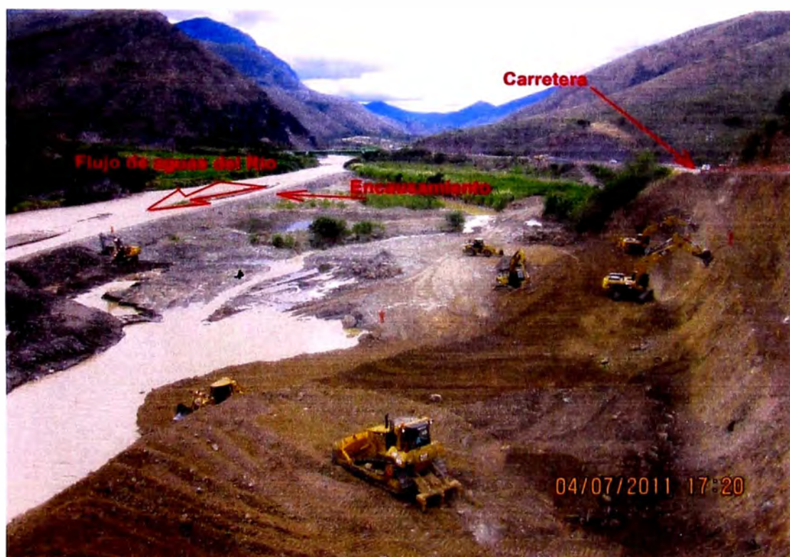
Foto 14: Km. 108 Los trabajos para mantener la carretera transitable demandan de gran inversión, se aprecia encausamiento del río en forma temporal y preparación del terreno para la construcción de muros de contención.
