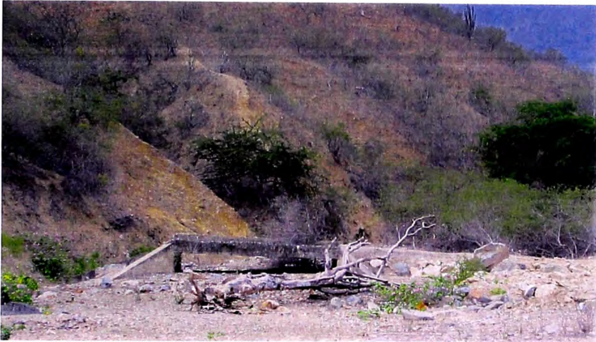
Foto 03: Km. 12 Vista aguas arriba de un río seco afluente al río Olmos, donde se observa un antiguo puente dañado.
