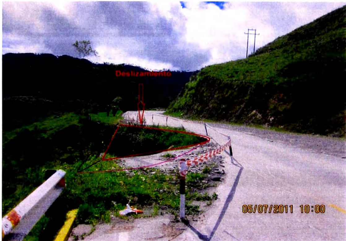
Foto 15: Km. 323 Los trabajos de rehabilitación son constantes en todo el trayecto, en la imagen se muestra un deslizamiento de la plataforma y a consecuencia se sigue dañando con manifestaciones de hundimiento.
