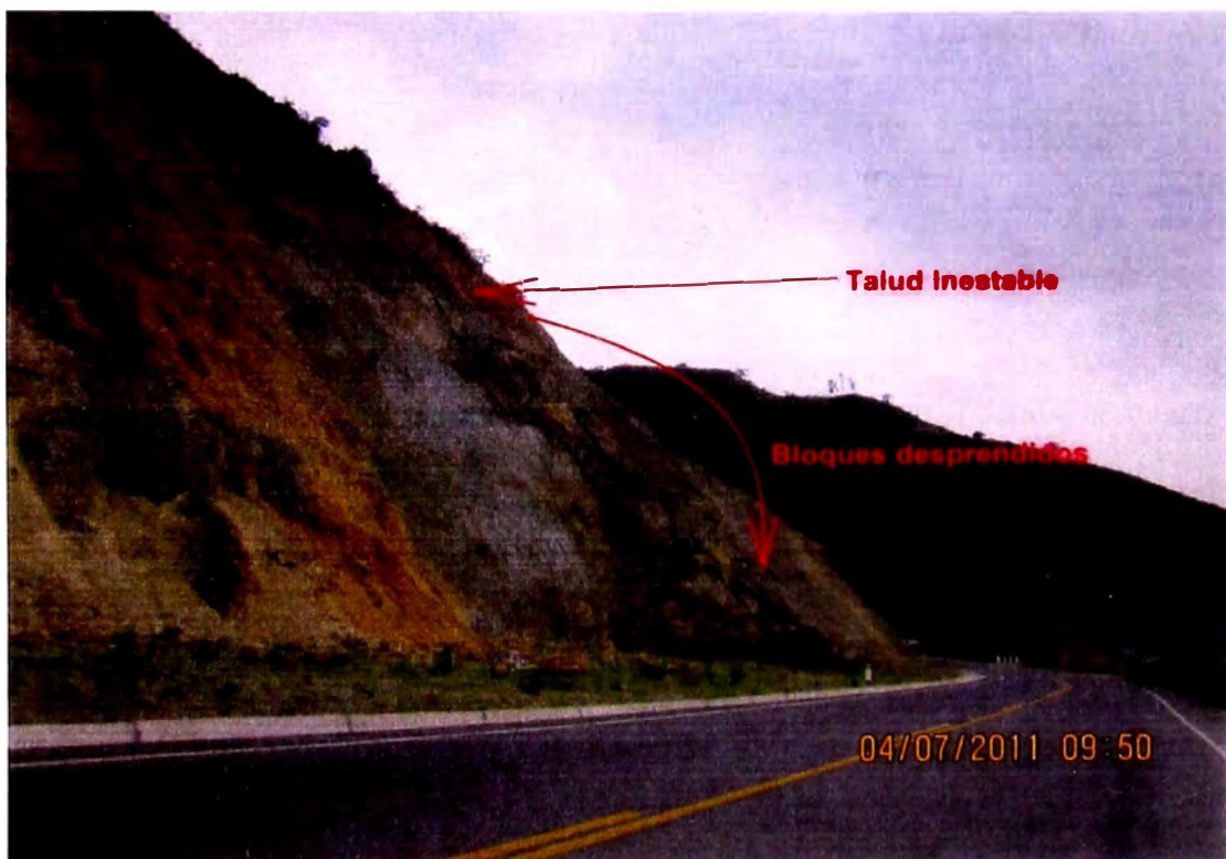
Foto 12: Km. 90 Se aprecia en distintos puntos de la carretera laderas inestables.
