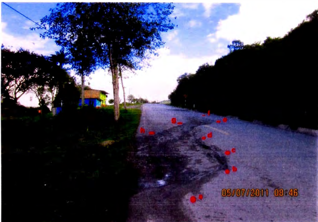
Foto 18: Km. 348 Se observa un proceso de falla del pavimento por un deficiente drenaje de la zona, manifestándose la ocurrencia de hundimiento de una geometría definida, debido al flujo de filtraciones en dicha dirección.
