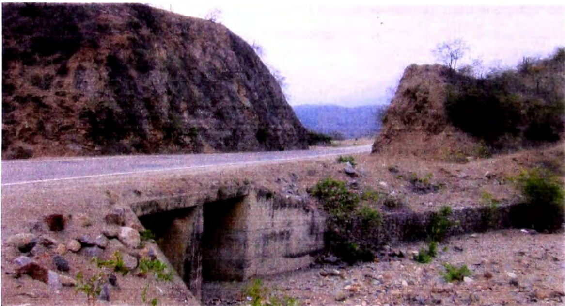
Foto 04: Km. 12 Vista del nuevo puente construido a 50 m aguas abajo del anterior (Foto 03), donde se aprecia la construcción de muros de gaviones para encausar las aguas en temporadas de lluvias y evitar la socavación en las alas del puente.
