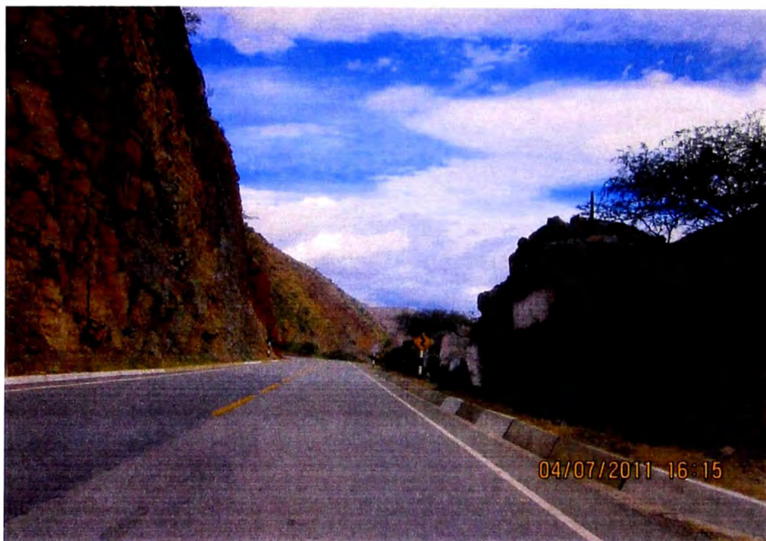
Foto 13: En el desarrollo de la carretera se aprecia cortes en roca, no teniendo espacio para realizar un trazo opcional.
