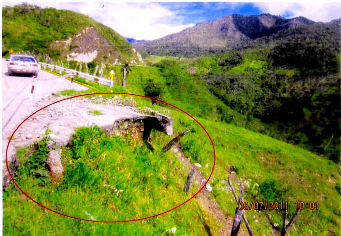
Foto 16: Km. 323 Se puede observar que el terreno de fundación no fue el adecuado, además no se construyó sistemas de drenaje.
