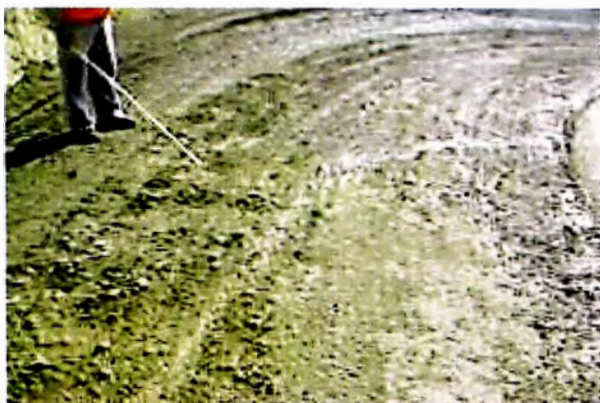
Fotografía 10 Determinación de Fallas km196 Fuente Elaboración Propia
