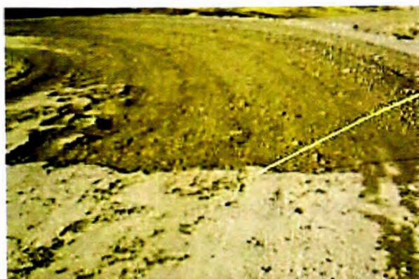
Fotografía 11 Determinación de Fallas km195 Fuente Elaboración Propia
