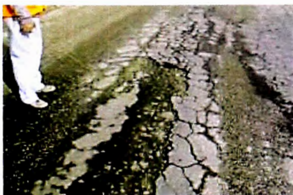
Fotografía 6 Determinación de Fallas km200 Fuente Elaboración Propia
