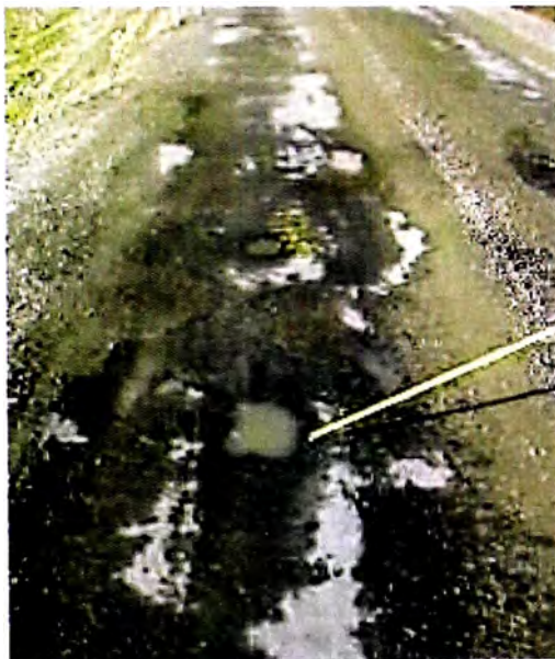
Fotografía 7 Determinación de Fallas km199 Fuente Elaboración Propia
