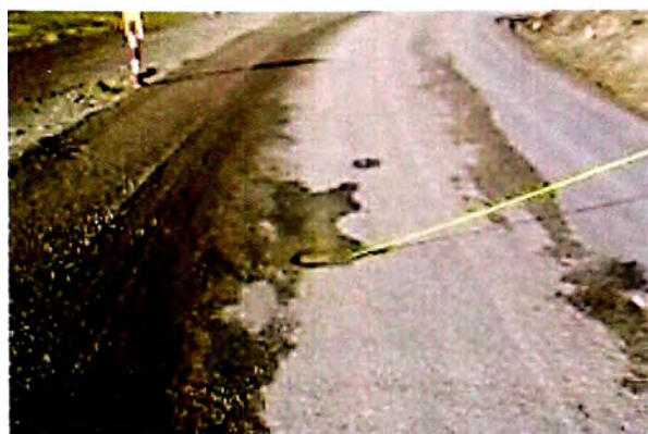
Fotografía 9 Determinación de Fallas km197 Fuente Elaboración Propia
