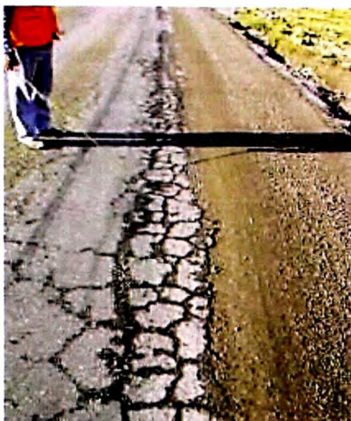
Fotografía 8 Determinación de Fallas km198 Fuente Elaboración Propia
