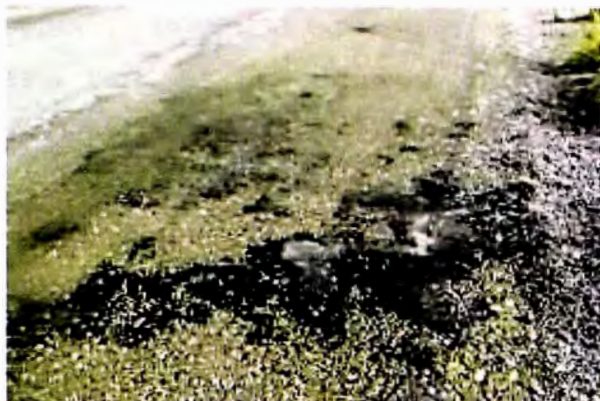
Fotografía 5 Determinación de Fallas km201 Fuente Elaboración Propia
