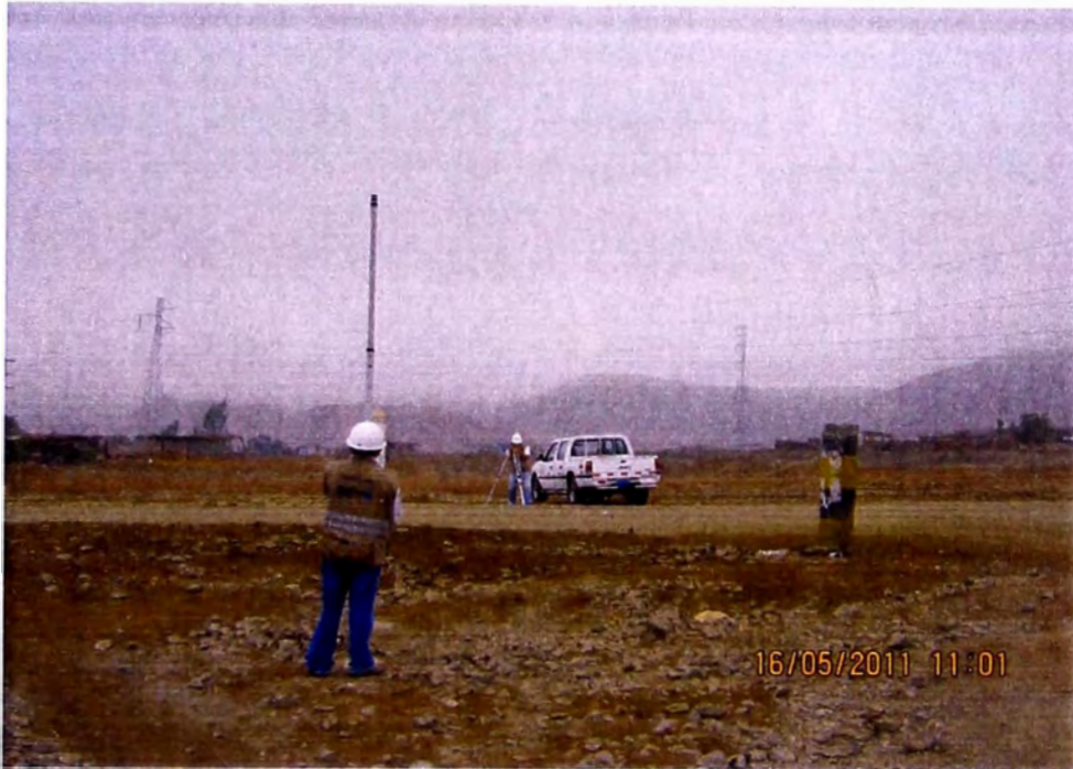
FOTON°11 UBICACIÓN DE BM4 (COTA=241.048), EN HITO DE CONCRETO UBICADA EN AVENIDA PRINCIPAL, EN DIRECCION AL PENAL, ENTRE LAS CALLES SANTA ROSA Y SAN VALENTIN
