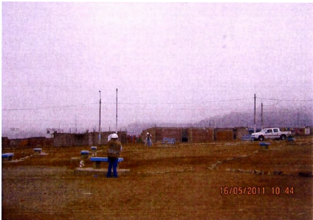
FOTON°02 SE CORRE NIVELACION PARA UBICACIÓN DE BMS A PARTIR DEL BM1 , SE INICIA DEL CENTRO DEL PARQUE
