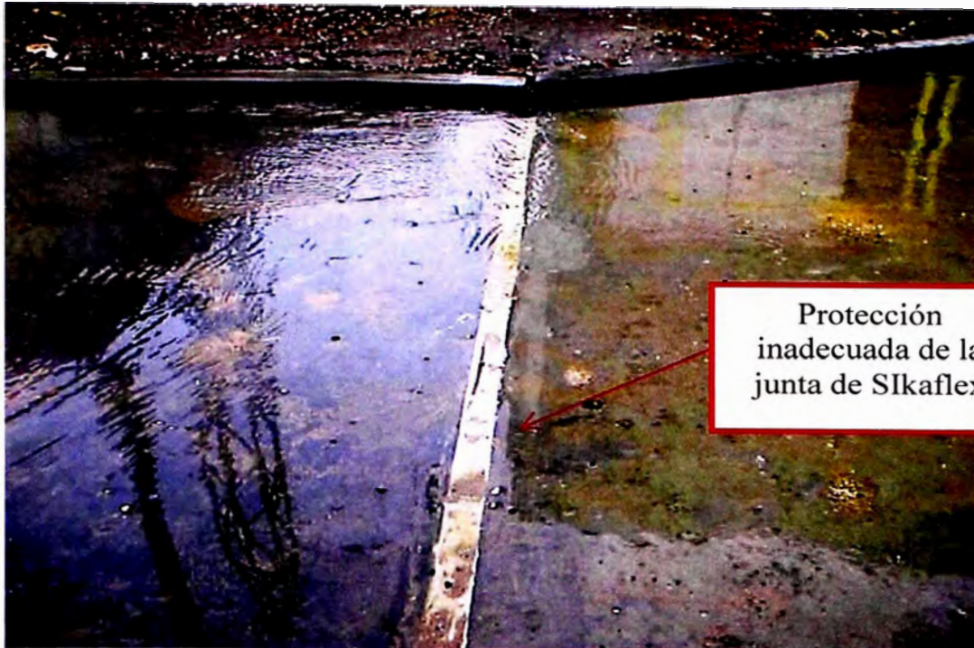
Losas de Planta ADR totalmente humedecida por lluvias
