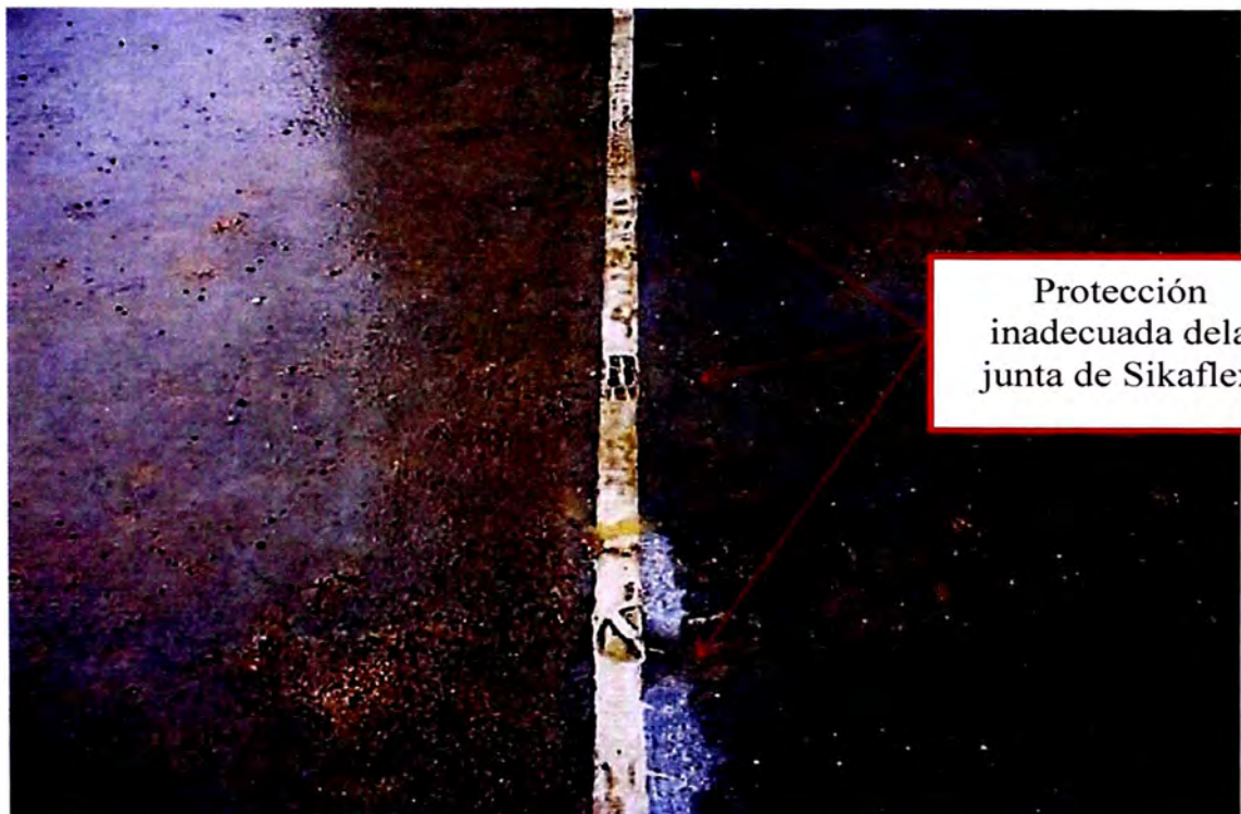
No se protegió adecuadamente la junta, luego de realizar los trabajos de colocado y acabado.
