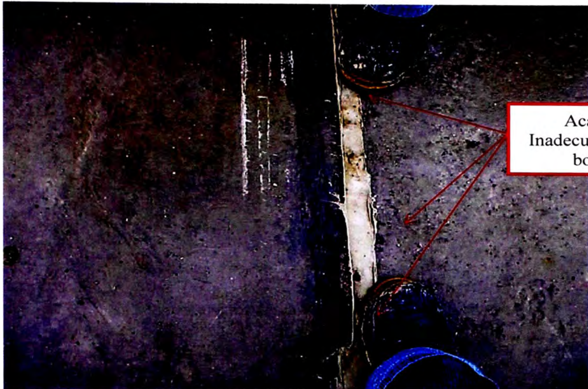
Trabajos de acabado descuidados.
