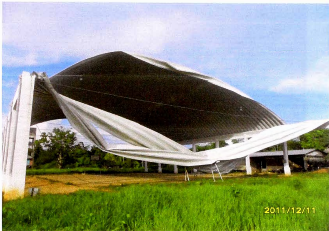
FIGURA N°18: Colapso por mala construcción de Viga Canal
