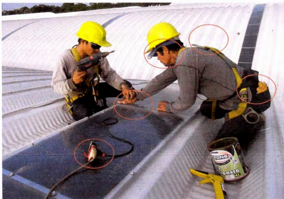
FIGURA N°19: Falta de medidas de seguridad
