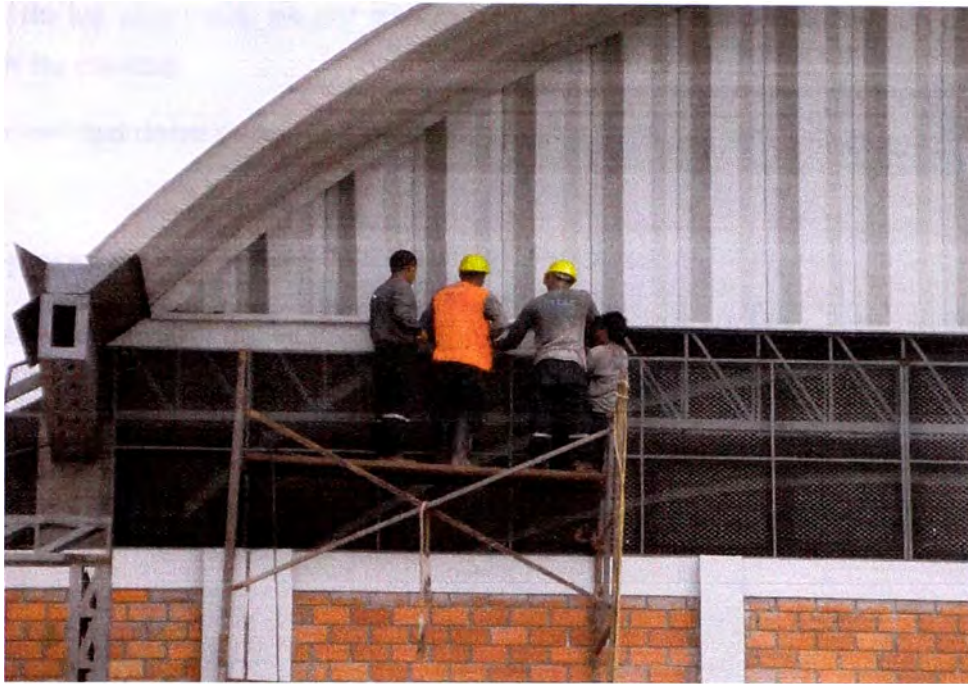
FIGURA N°20: Falta de seguridad en la instalación de tímpanos
