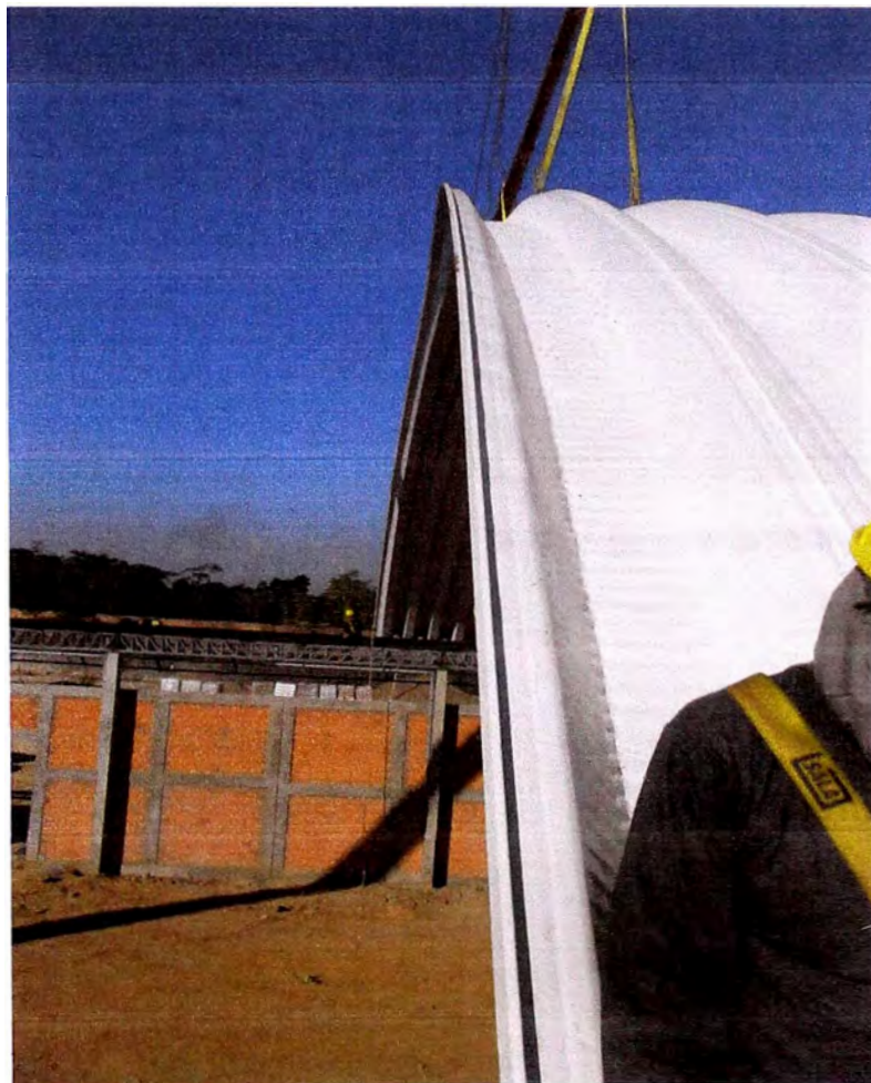
FIGURA N°12: Deformación de arcos en montaje que se da por un mal control de la curvatura del arco fabricado al momento de la producción
