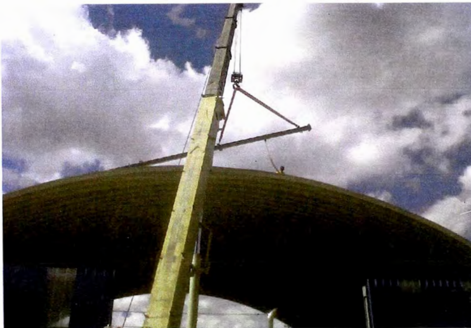
FIGURA N°17: Balancín roto en plena maniobra de izaje
