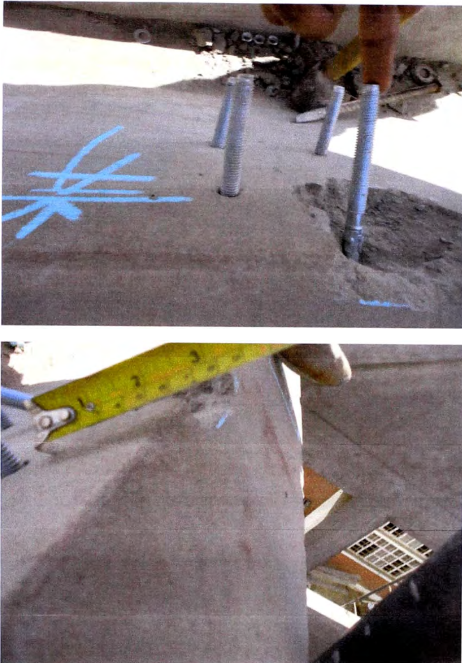
FIGURA N°15: El tarrajeo tiene más de 7cm, por lo que al momento de colocar los pernos de expansión donde se anclará la cobertura, los 2 superiores se sujetaron al tarrajeo, no cumpliendo de ésta manera con su función de soporte de la estructura.
