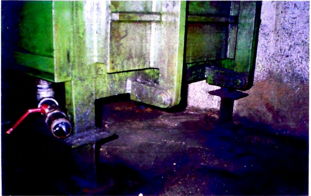
Foto 4.6 Válvula de evacuación del tanque
