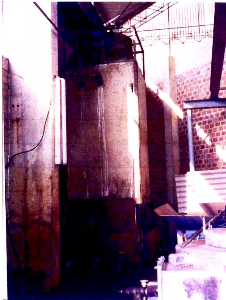
Foto 4.7 Torre de enfriamiento de la planta.
