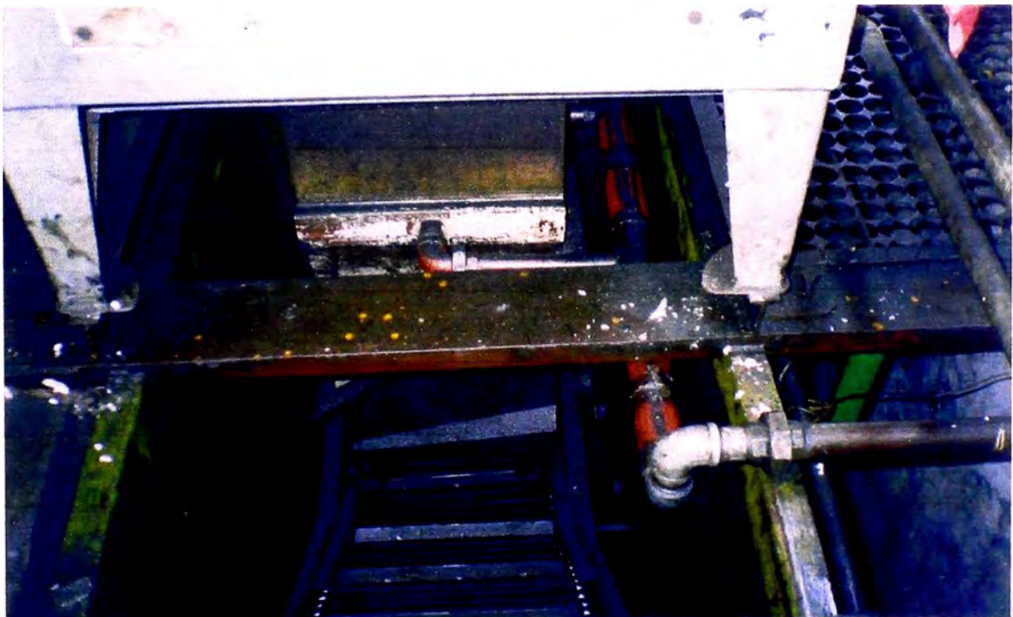
Foto 5.1 Anclajes de las patas del horno y de la estructura mediante pernos
