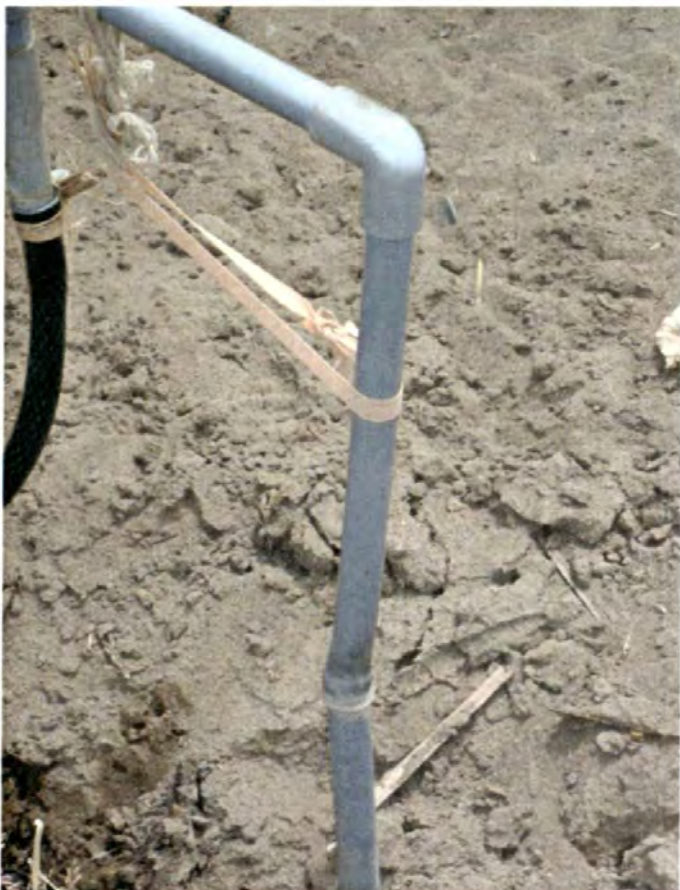
Foto N° 6: Conexiones existentes – Vista 1
