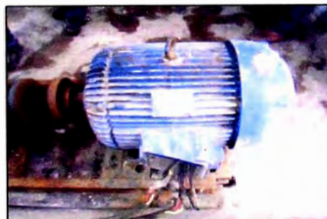
Figura 2.2: Motor de impulsión de la estación Las Lagunas
