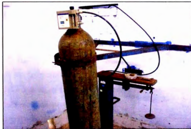
Figura 2.3: Equipo de cloración en la estación Las Lagunas
