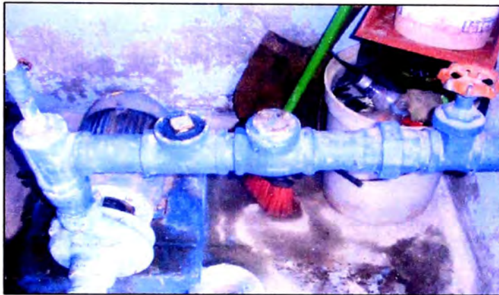
Figura 2.6: Equipamiento hidráulico en la estación de rebombeo
