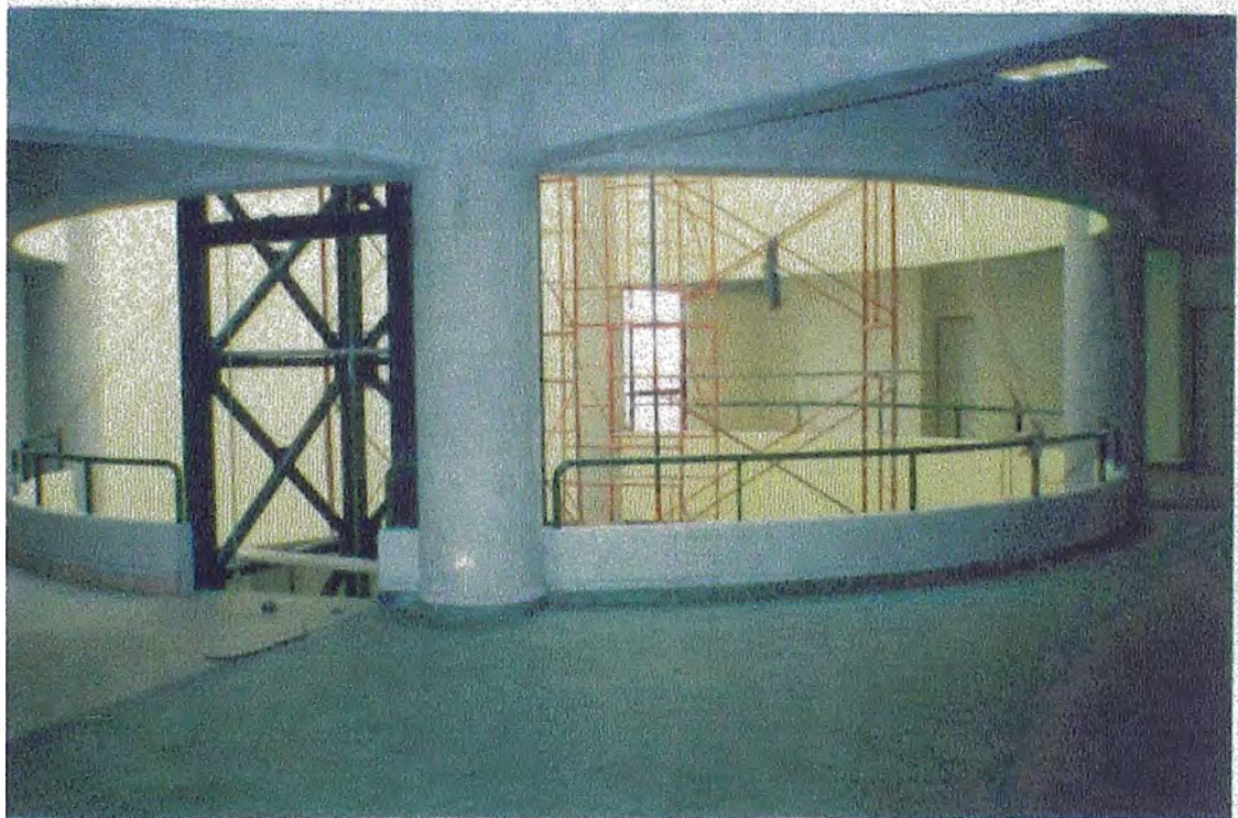
Fotos 8 y 9: El cilindro. Durante su construcción se aprecia la expresión de la estructura metálica de soporte para el ascensor, tal cual el proyecto, antes de ser revestida con cristal.
