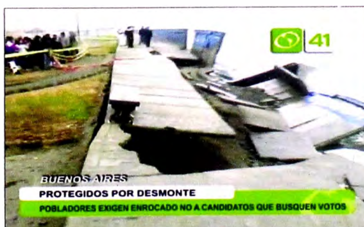
Figura 3.04. Colapso de obra Paseo marítimo, por avance de la erosión costera
