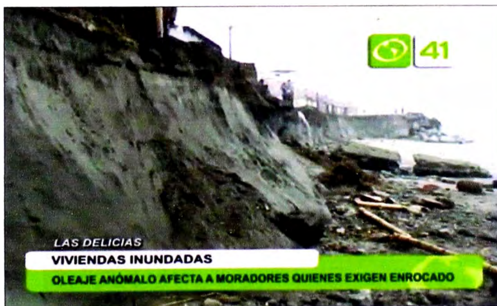
Figura 3.01. Fuerte oleaje socaba cimentación de las estructuras existentes.
