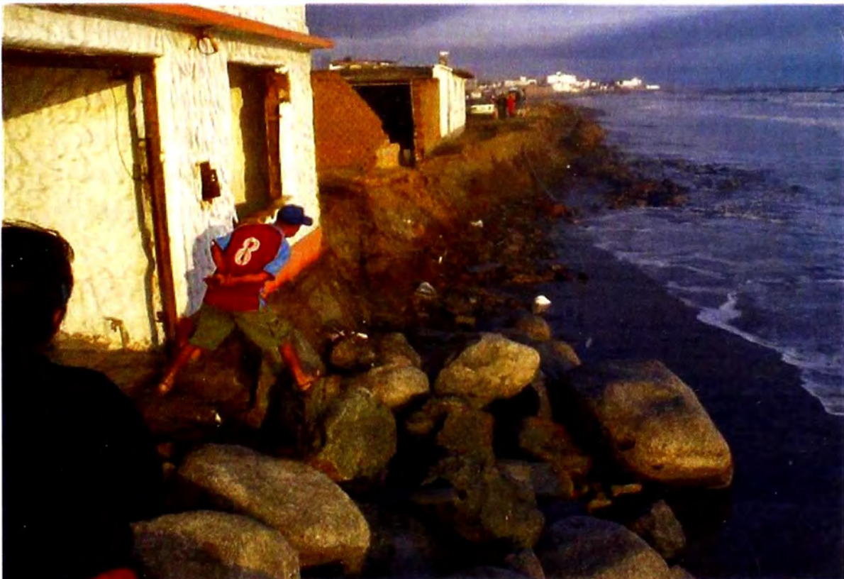
Figura 3.01 Erosión en la zona norte del puerto, playa Las Delicias.
