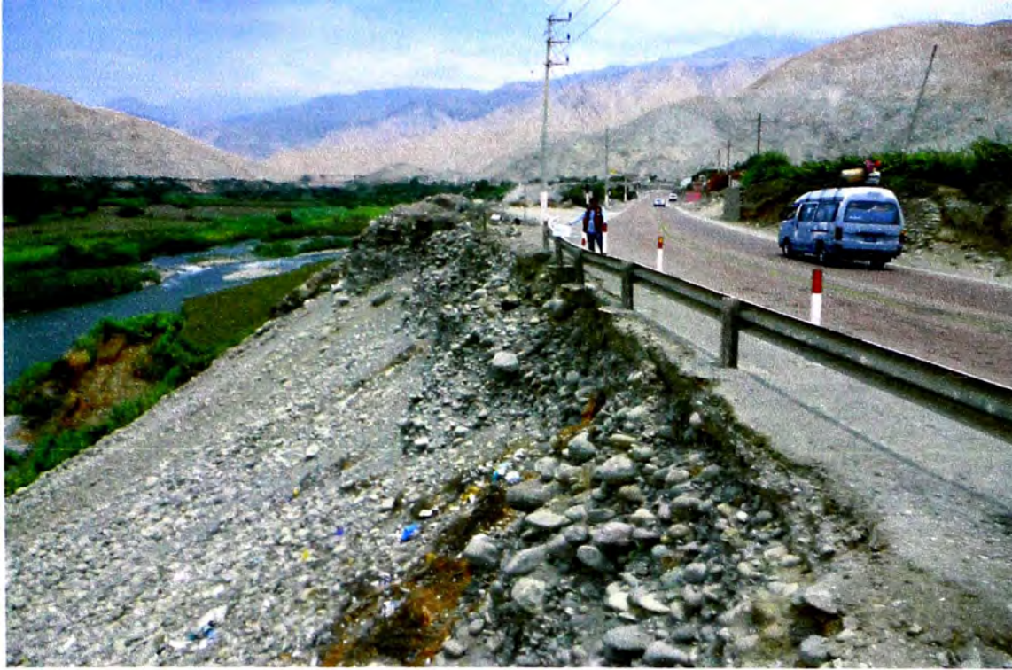
Foto 05: Se aprecia las guardavías que se encuentran en un borde de la carretera que ha sido erosionada y que demandara otro tipo de señalización, al tener cuidado de acercarse a la berma lateral.
