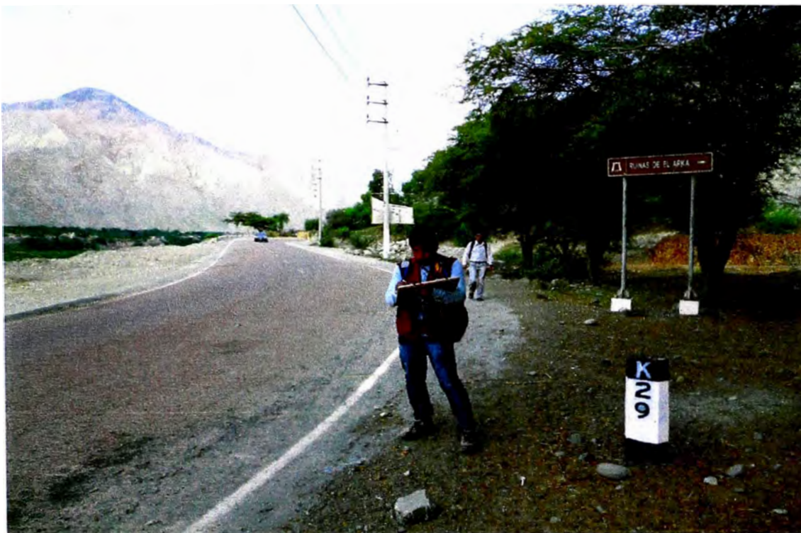
Foto 10: Se muestra el hito kilométrico en muy buen estado, más allá se aprecia una señal de lugar turístico o arqueológico, se puede apreciar que las líneas central, no resala por su desgaste.
