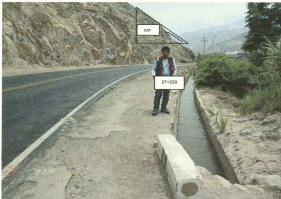
Foto N° 6: Caída de roca km 27+220, realizar labores de desquinche, ángulo de talud de 35°.
