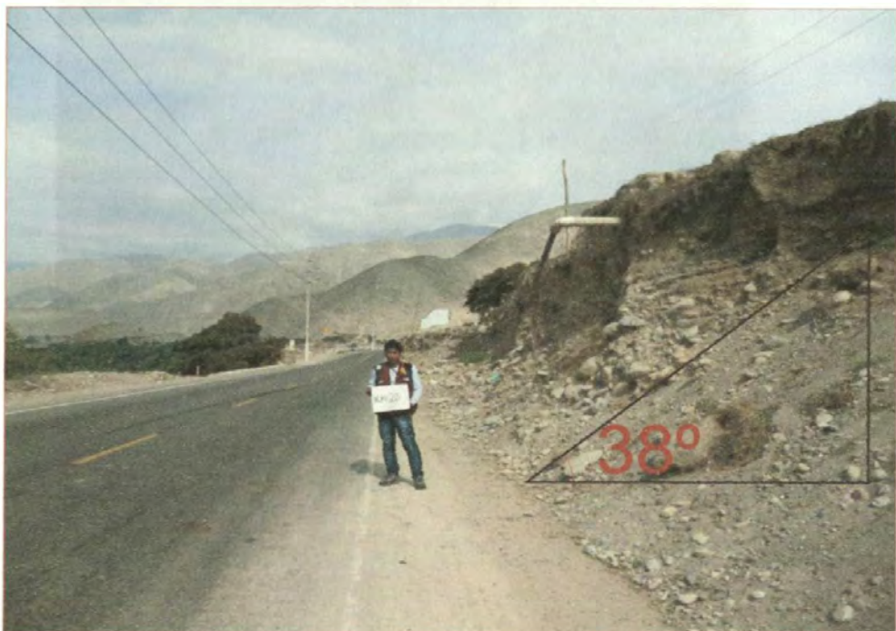
Foto N° 8: Caída de piedras km 28+560, se debe realizar la construcción de muro de contención, ángulo de talud de 38°.
