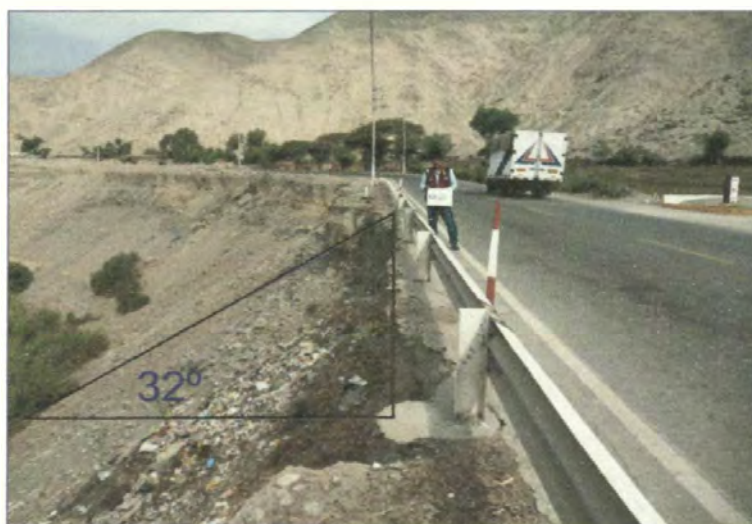
Foto N° 10: Erosión de plataforma km 28+920, se debe realizar la construcción de un enrocado, ángulo de talud de 32°, talud inestable.
