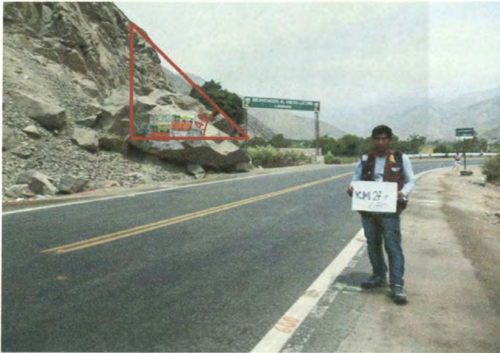
Foto N° 7: Caída de roca km 27+680, se debe realizar la conformación de banquetas a la hora de explotar la cantera, ángulo de talud de 46°.
