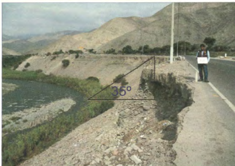
Foto N° 9: Erosión de plataforma km 28+840, se debe realizar la construcción de un enrocado, ángulo de talud de 35°, talud inestable.
