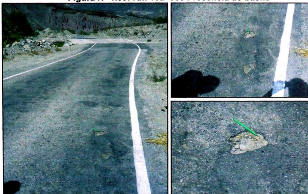
Figura N° 1.09: Km 102+350 Presencia de bache
