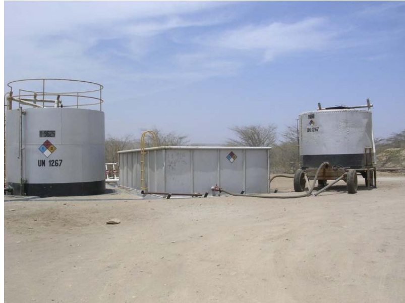
Figura 10.- Equipos portátiles para pruebas de producción.
