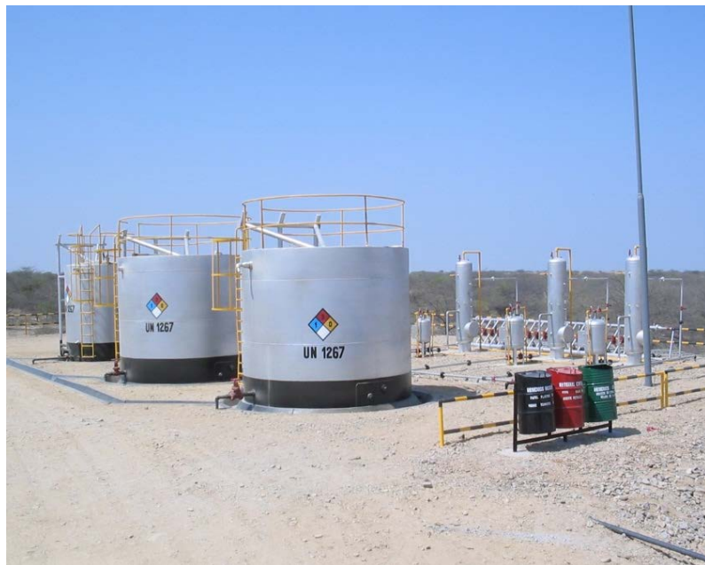
Figura 22.- Sistema de protección en tanques
