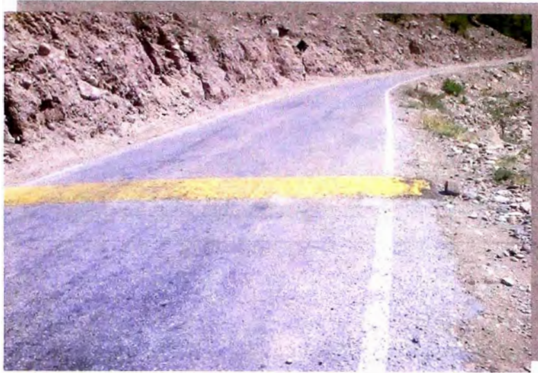
Figura 3.7: Giba en el tramo Km.108 – Km 109
