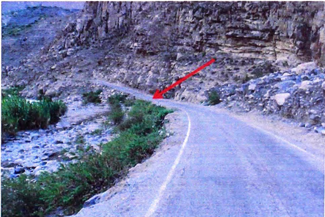
Imagen No 4: Indica un tramo crítico muy próximo a la rivera del río, Km 115 +000 - 116+000
