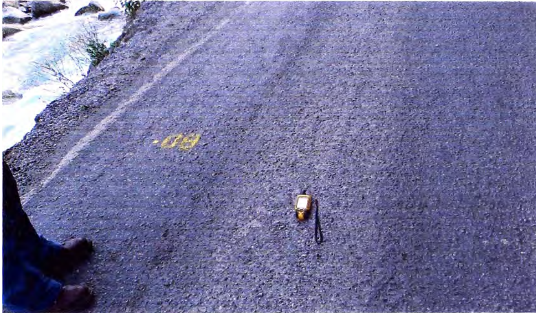
Figura N° 4.04: Estado de la Superficie de Rodadura
