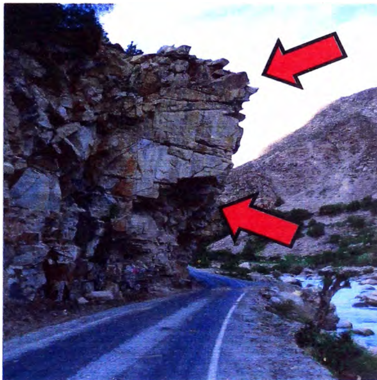
Imagen No 6: Señala un talud de roca granodiorita fracturada. Punto de potencial desprendimiento de bloques rocosos, que pueden afectar la vía.
