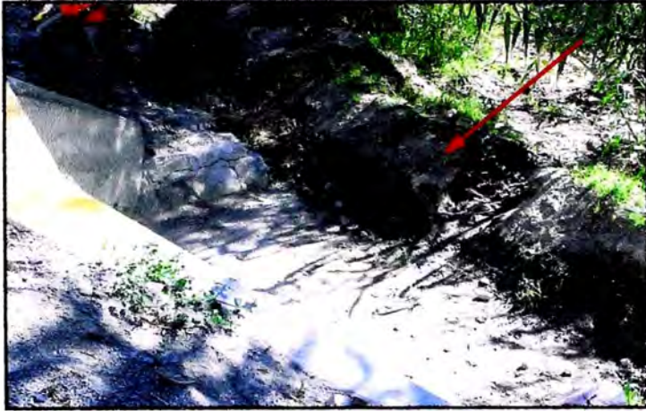
Fotografía N° 1.16: Alcantarilla con deficiente encauzamiento
