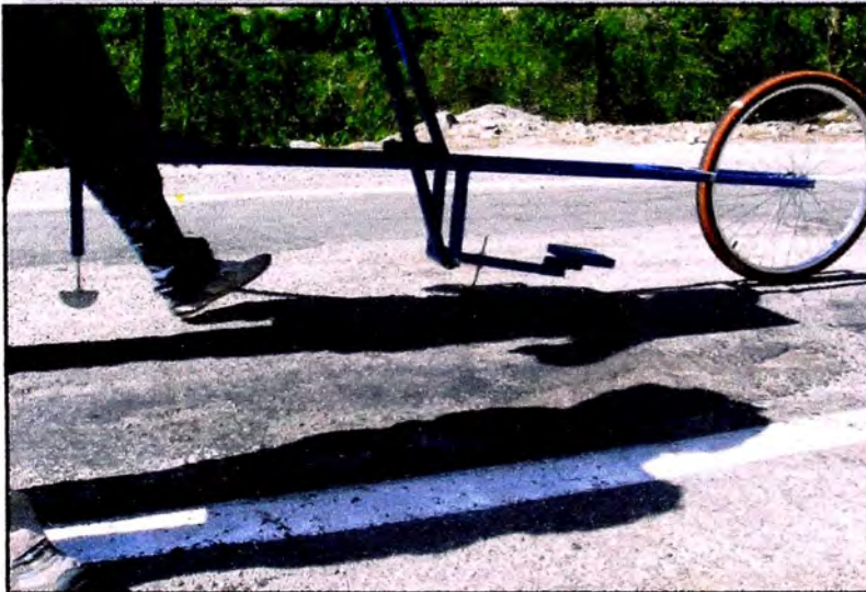
Fotografía N° 5.02: Aquí observamos como el mantenimiento rutinario que se está realizando y consta en parte de parchados con slurry seal, afectan los resultados del ensayo con el Merlin.
