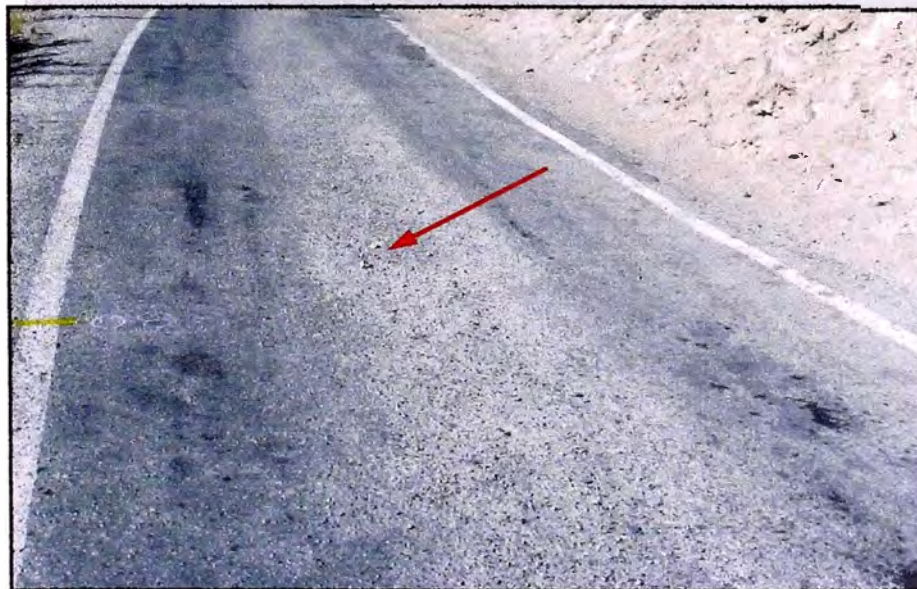
Fotografía N° 5.05: Desprendimiento de la gravilla de 3/8" en la carpeta de monocapa asfáltica.
