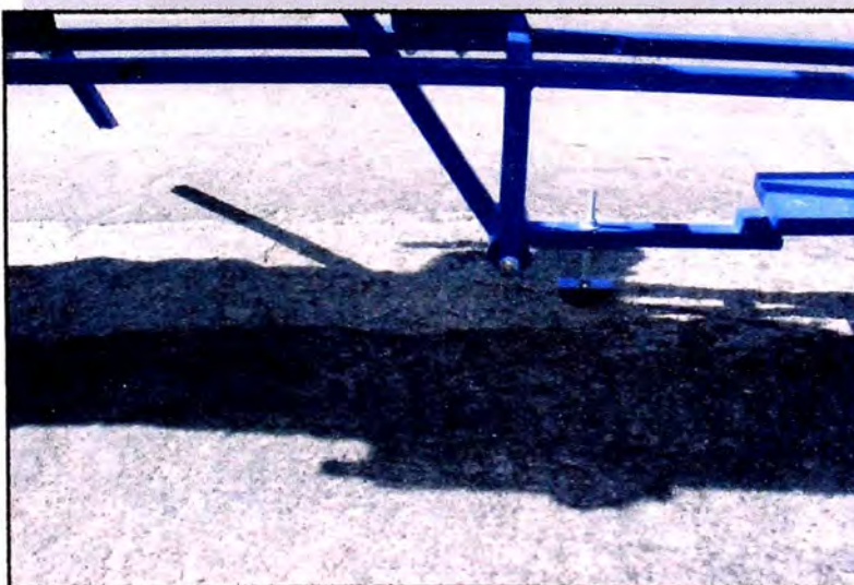
Fotografía N° 5.03: Se observa el desgaste producido en la carpeta de rodadura con tratamiento de monocapa asfáltica
