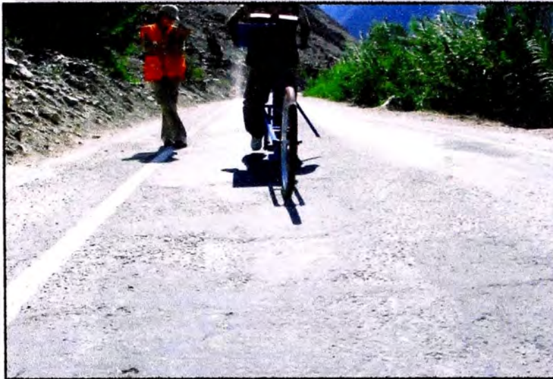
Fotografía N° 5.01: Aquí se observa el deterioro de la superficie de rodadura.
