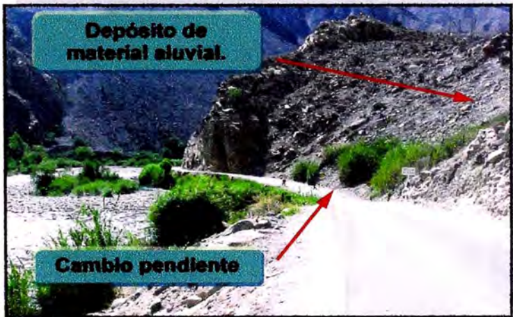
Fotografía N° 1.17: Falta mejorar el drenaje transversal en el cambio de pendiente
