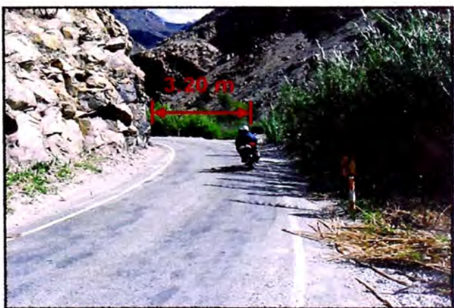
Fotografía N° 1.04: Anchos de calzada muy angostos para un flujo en doble sentido.
