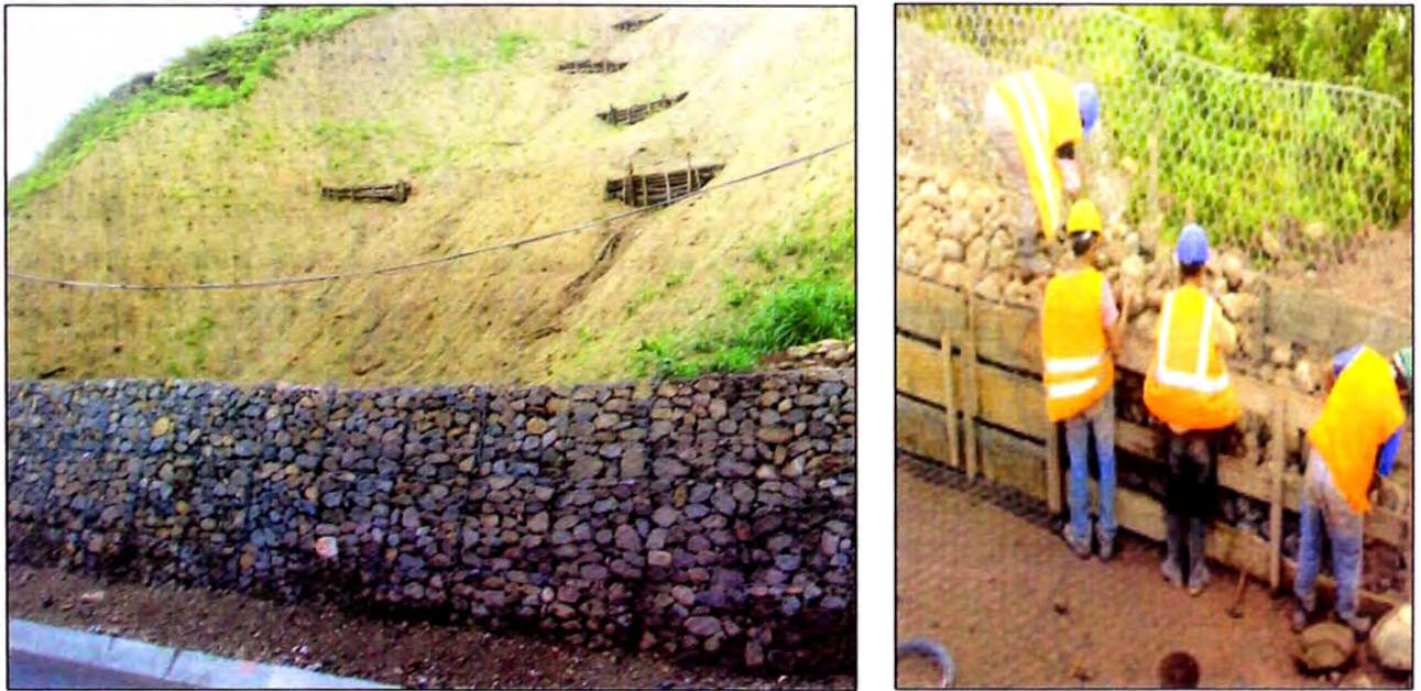
Grafico 02.15.- Estructuras de gaviones
