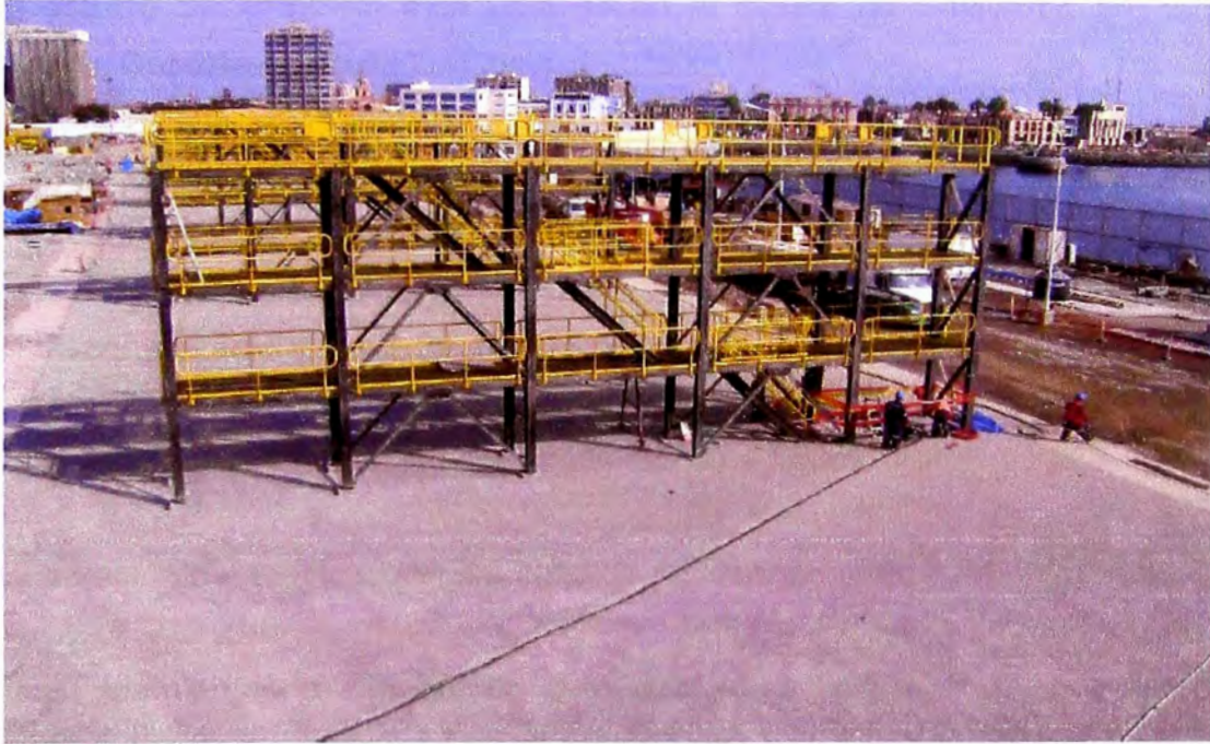
Figura 2.21 Estructuras metálicas (Reefers) para almacenar contenedores refrigerados.
