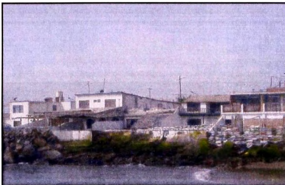
FIGURA N° 1.5: Inestabilidad y des-habilitación de viviendas
