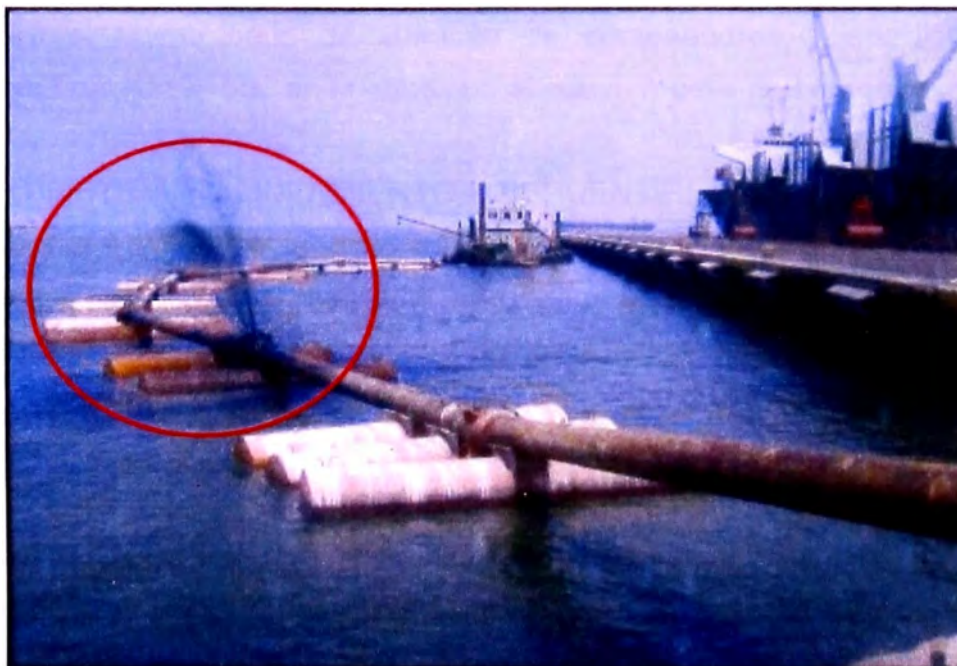
FIGURA N° 2.13: Contaminación por la fuga en el proceso de dragado en el TPS
