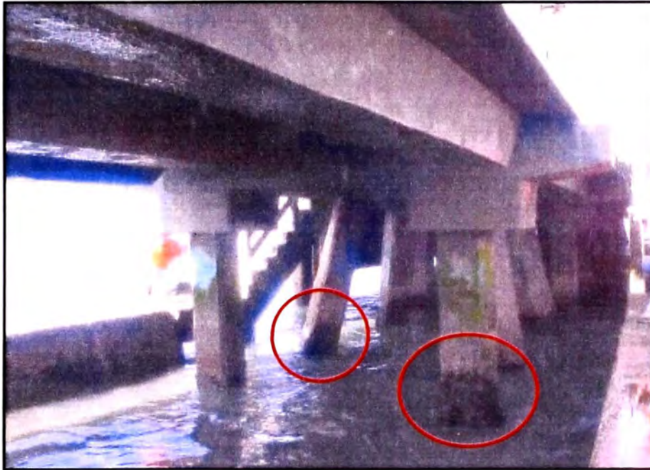
FIGURA N°1.6: Desgaste del concreto en pilotes debido a la corrosión
