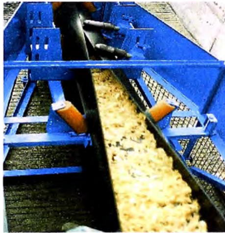
FIGURA N° 3.7: Carga de Faja tubular
