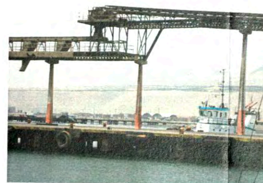
Foto N° 07: Faja Transportadora de Azúcar Hacia el Muelle
