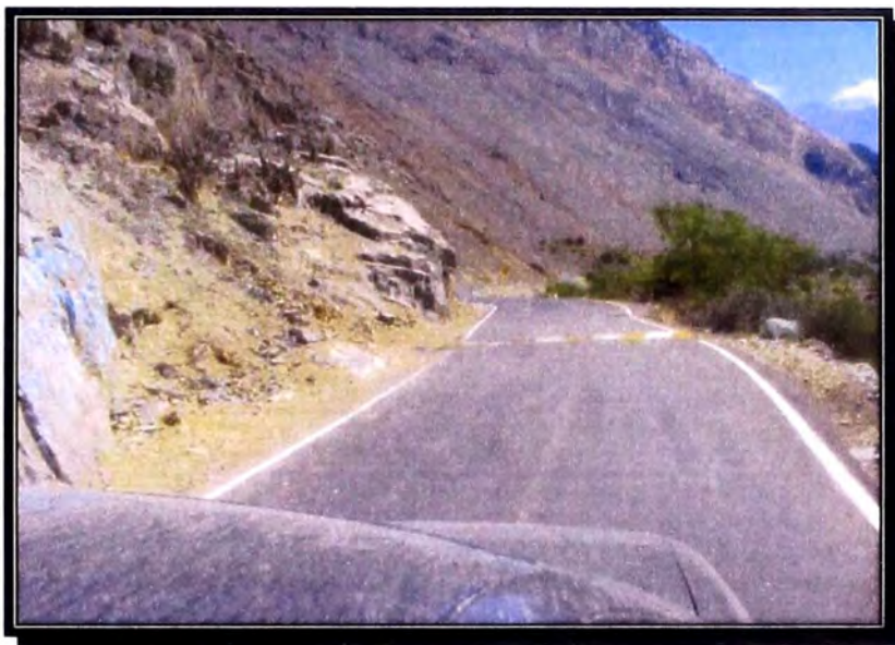
Presencia de Gibas en partes de las Vías
