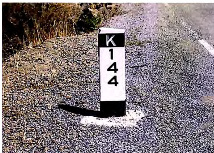
Se puede apreciar la disgregación del pavimento en monocapa.
