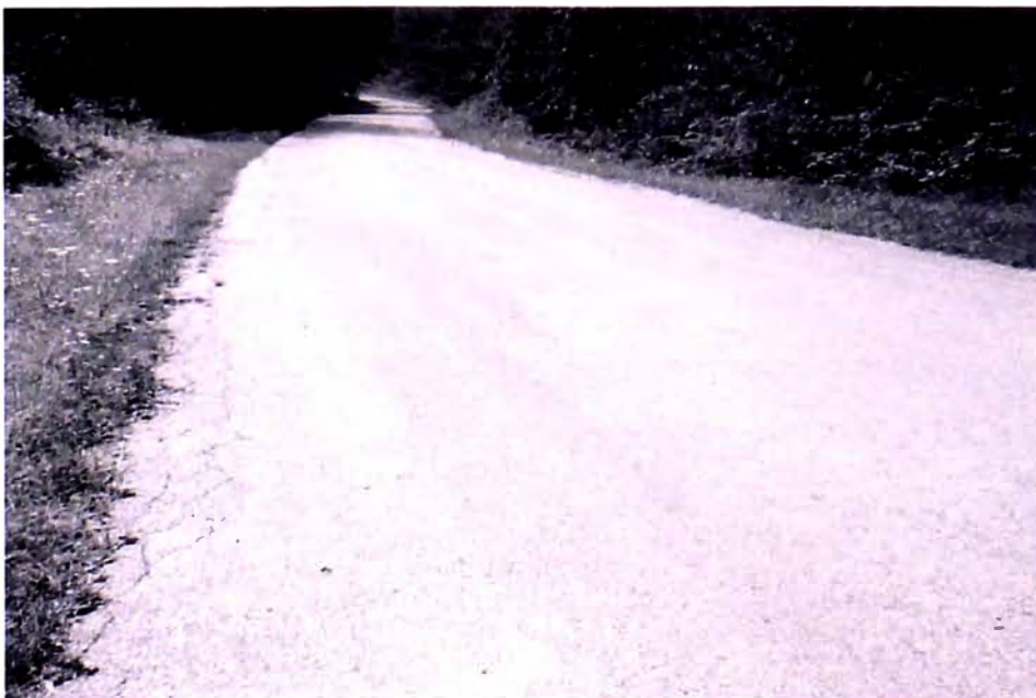
Superficie de 5 años de edad; grietas de borde; necesarias mejoras en el drenaje.
