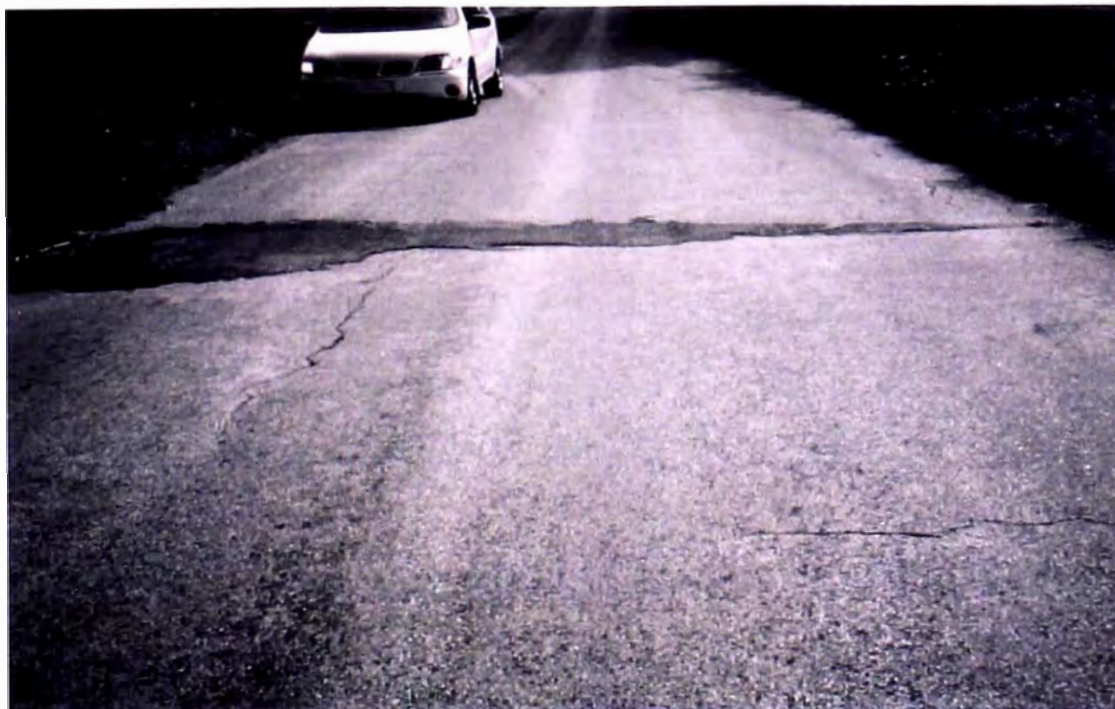
Superficie de 4 años de edad; desgaste moderado de la superficie, buena reparación de alcantarillas.
