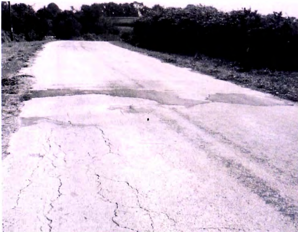
Drenaje en regular estado; requiere parchado y nueva superficie de sellado.
