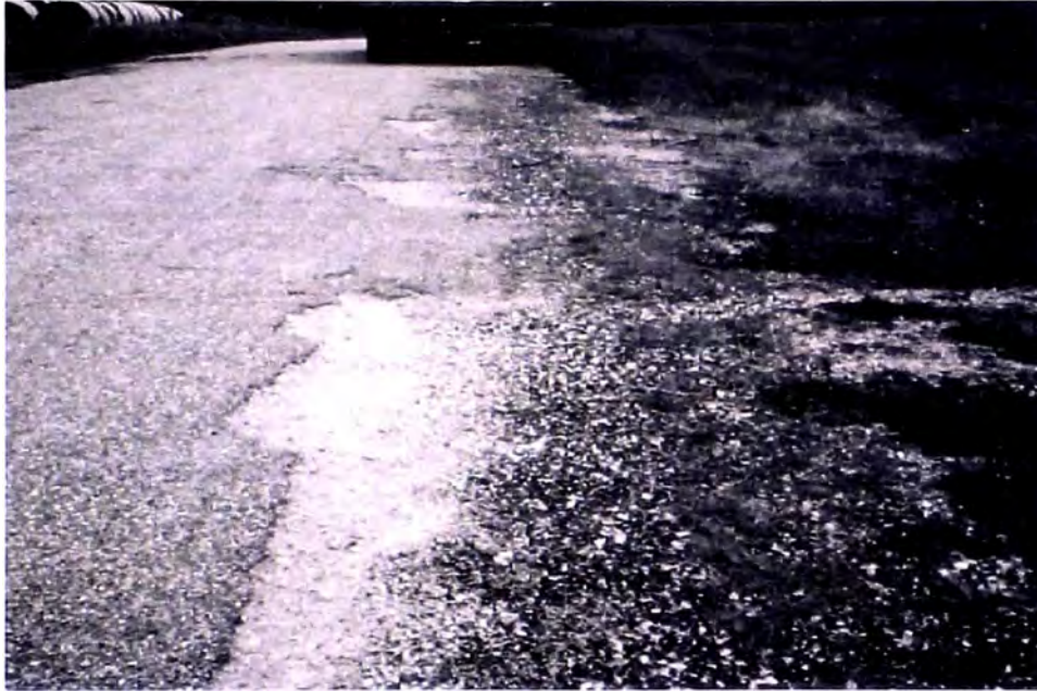
Zanjas extensas, mejoras necesarias, parches necesarios.
