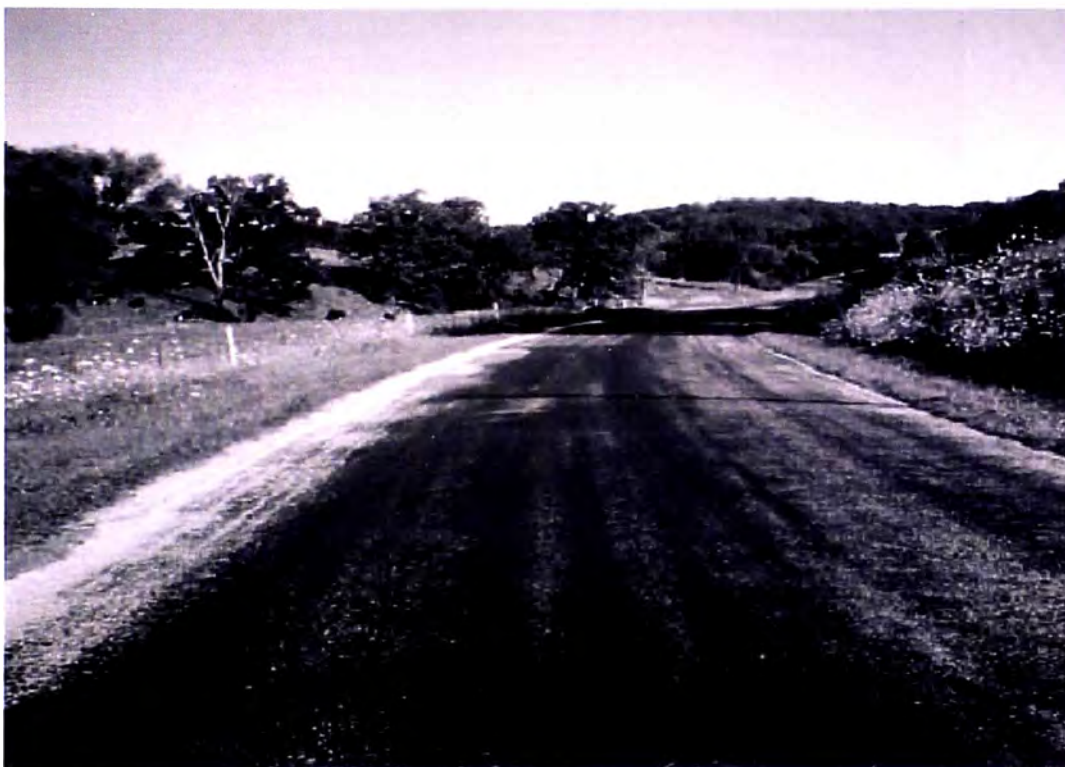
Superficie de 3 años de edad; extensa pérdida del agregado.
