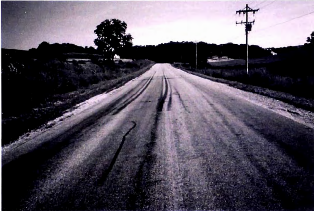
Superficie de 3 años de edad; pérdida del agregado y desgaste. Buen drenaje.
