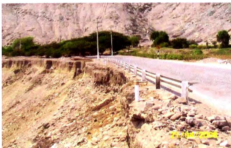
Figura N° 1. 8: Erosión en tramo asfaltado
