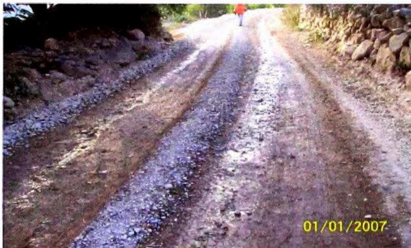
Figura N° 1. 9: Ahuellamiento en tramo no pavimentado
