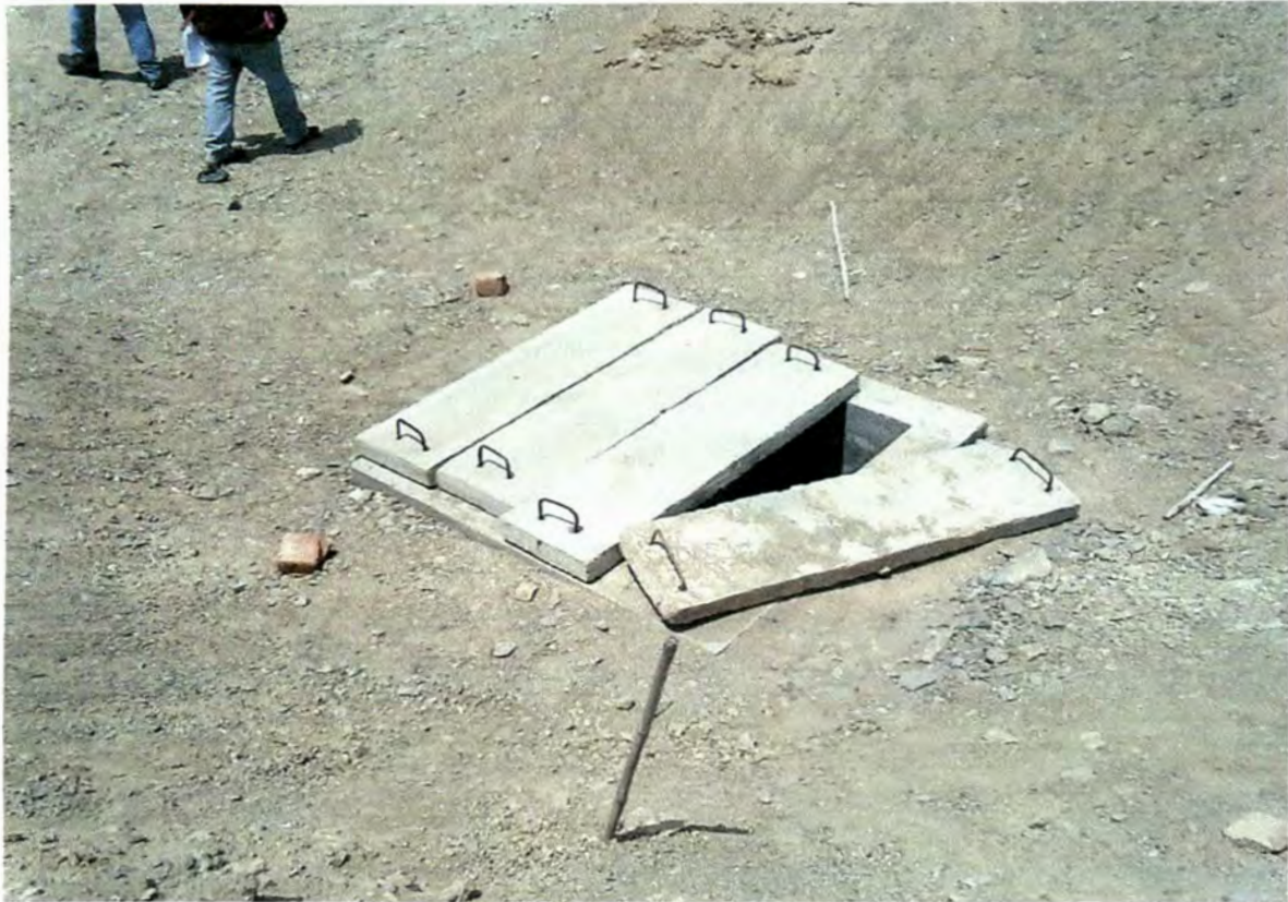
Fotografía N° 11: Cámara de Distribución
