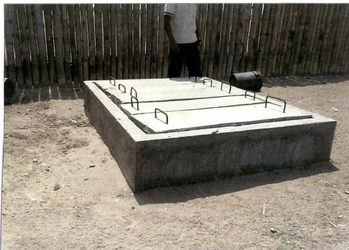
Fotografía N° 05: Cámara de Rejas
