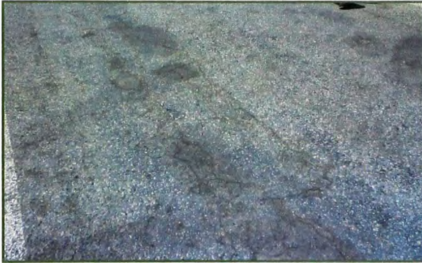
Figura N° 5.06 Falla en Bloque.
