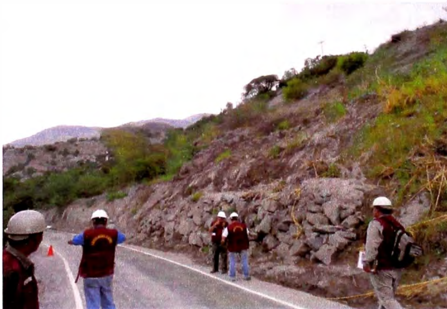
Fig. 5.14: Fotografía de la progresiva Km 80+200, se observa un sector crítico con posibles derrumbes pequeños, en temporada de lluvias tener una cuadrilla permanente.
