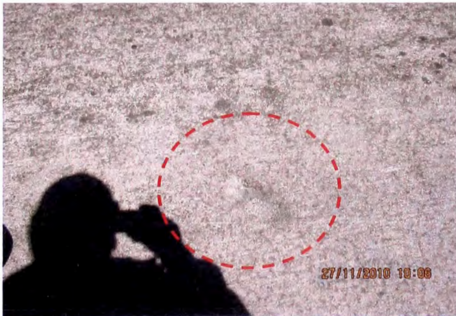
Fig. 5.12: Fotografía de la progresiva Km 75+800, se observa un pequeño hueco el cual debe ser sellado urgente para que no se extienda.
