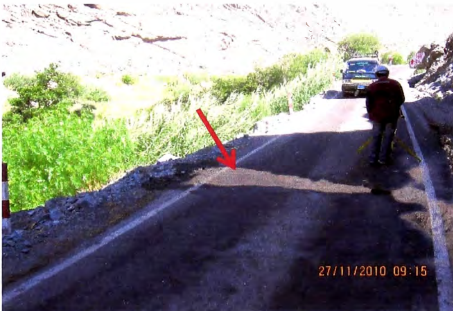
Fig. 5.10: Fotografía de la progresiva Km 74+800, presenta drenaje superficial por filtración del canal al lado derecho.
