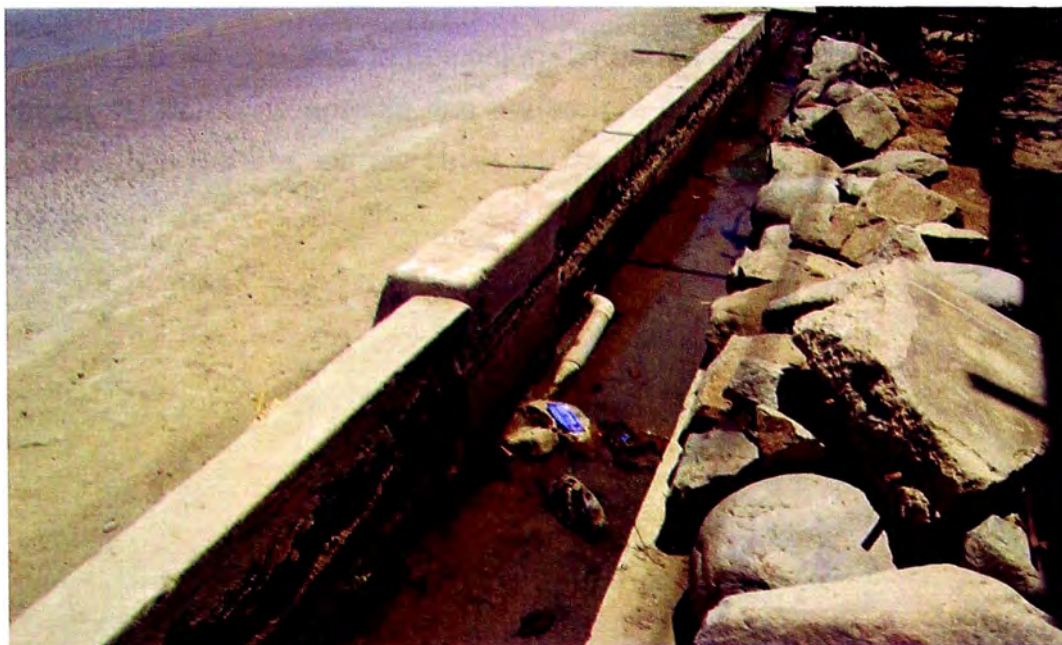
Foto N° 3.4. km 33 + 040 Se aprecia el canal de concreto ligeramente obstruido por desechos, piedras y sedimentos.
