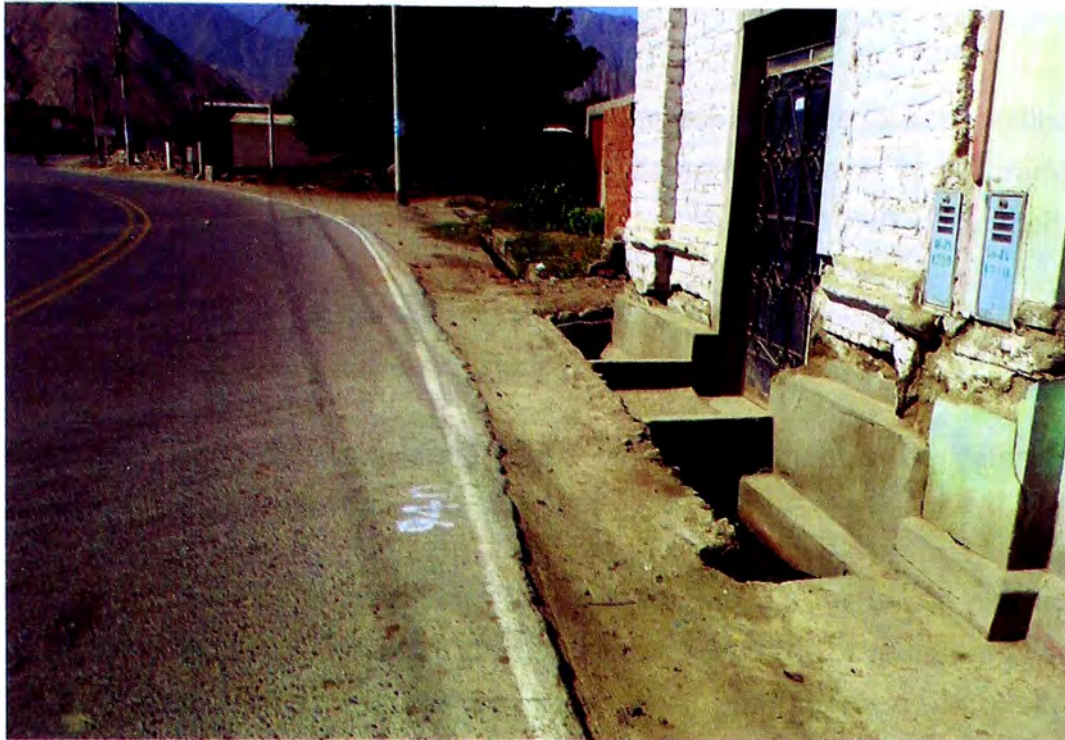
Foto N° 3.3. km 34 + 940 se puede apreciar el material de mampostería en la parte que colinda con la vía y de concreto al otro extremo. También se puede notar que las viviendas se encuentran bastante cercanas a la carretera motivo por el cual se recomienda la implementación de pases peatonales.
