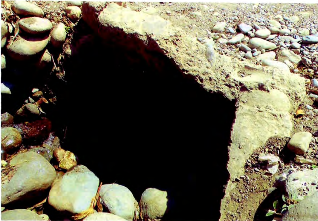
Foto N° 3.2. km 34 + 329 Alcantarilla totalmente obstruida.
