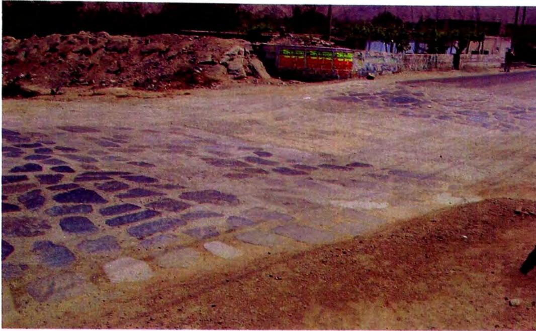
Foto N° 3.5. 33 + 025, badén San Jerónimo. Se puede apreciar la losa de concreto y el enrocado desgastados.
