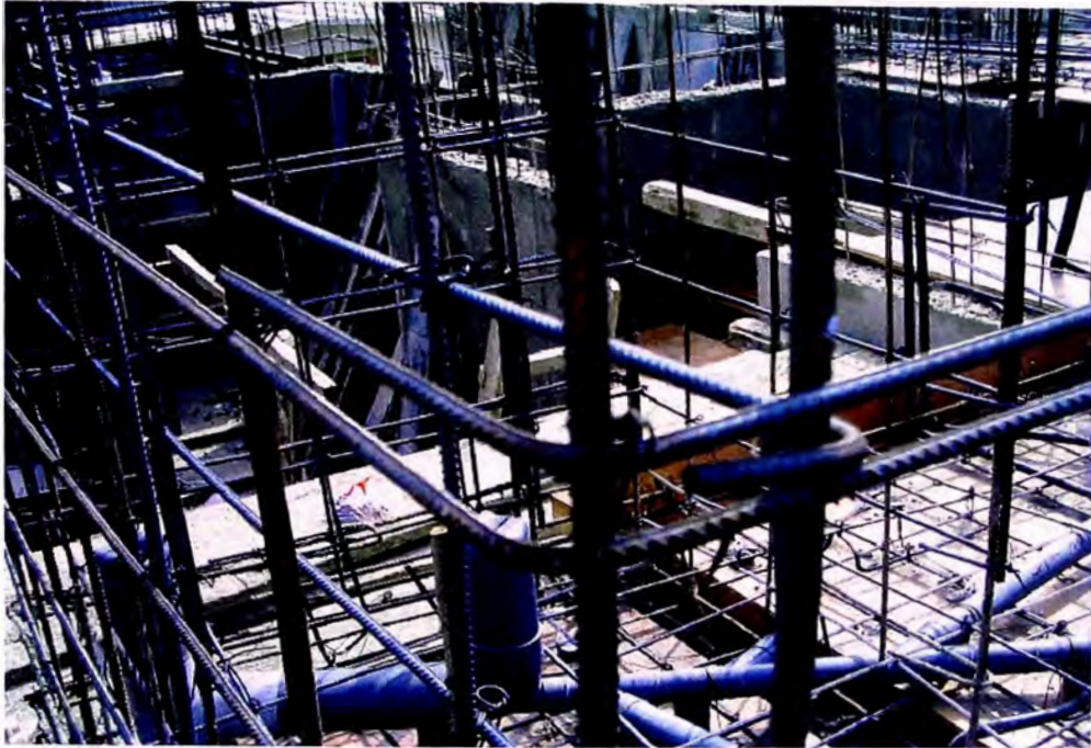
Fotografía N° 09. Vista de longitud de desarrollo del acero horizontal del muro de concreto.
