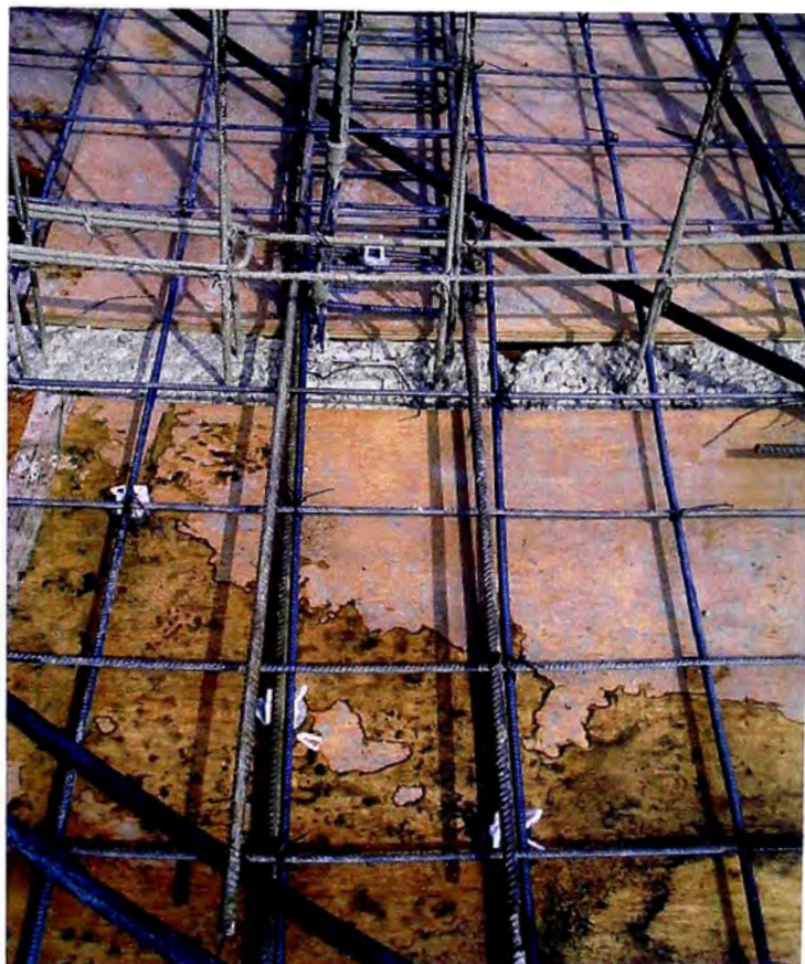
Fotografía N° 12. Detalle de anclaje de viga en losa. Obsérvese el tramo de la viga en la parte baja carente de estribos. Ver Fig. N° 28
