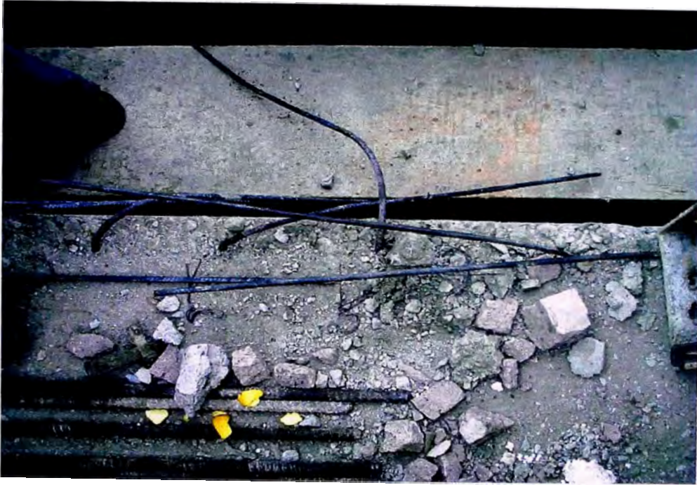
Fotografía N° 05. Detalle de acero doblado en ventana. Ø 3/8" que regresará a su posición en 90°. Ver Recomendaciones
