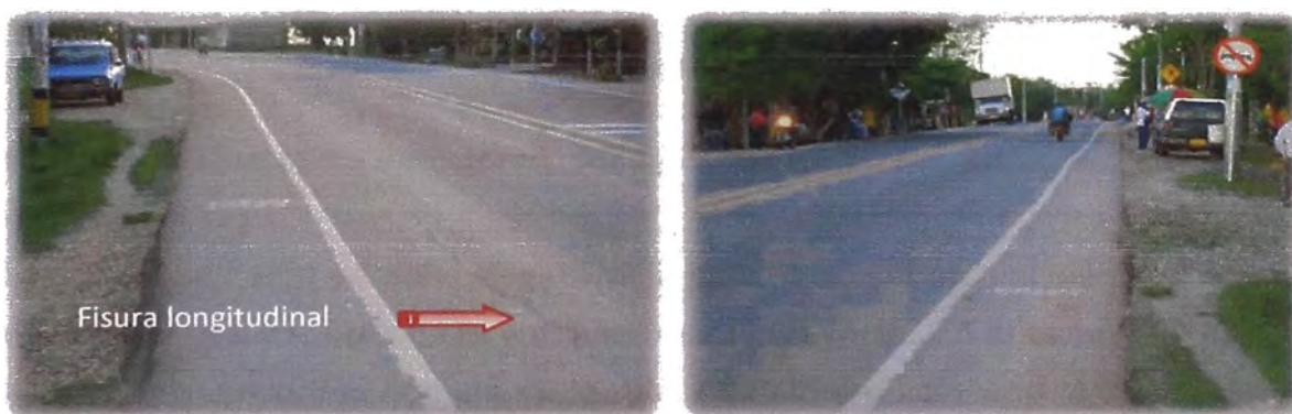
Figura N° 4.06: Incidencia de los rayos solares en la observación visual de las fisuras en un pavimento flexible.
