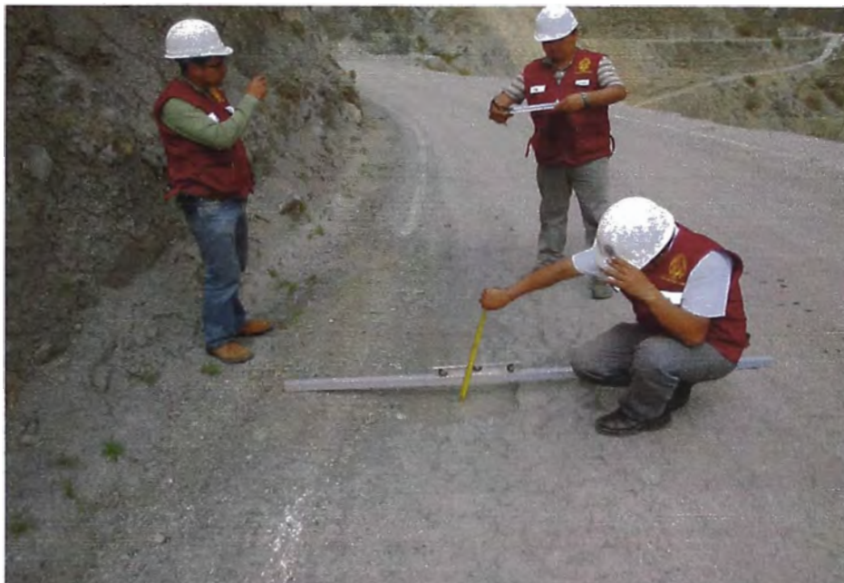
Fotografía N° 3.03: Identificación y registro de los tipos de daño.
