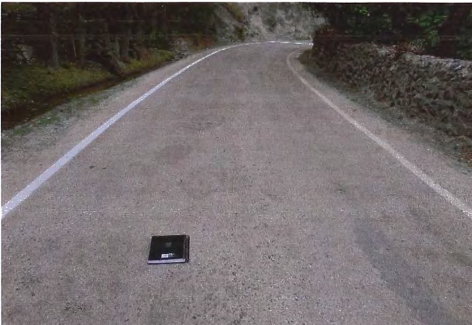
Fotografía N° 3.06: Pérdida de ligante.
