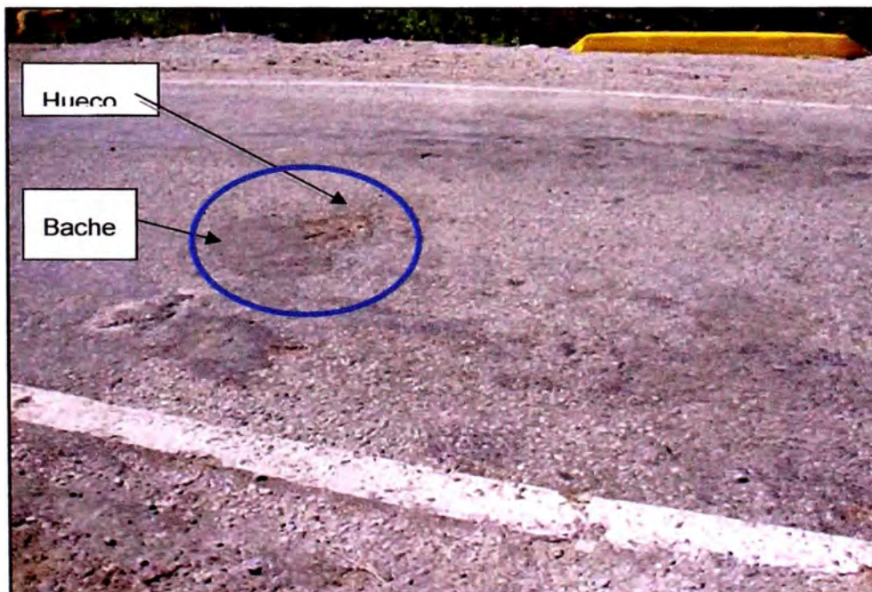
Foto N°2.3: Descascamiento al costado de bache en vía
