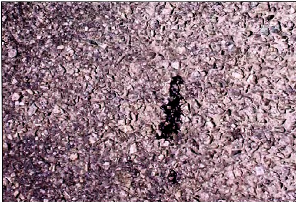
Foto N°2.1: Superficie de rodadura con presencia de exudación
