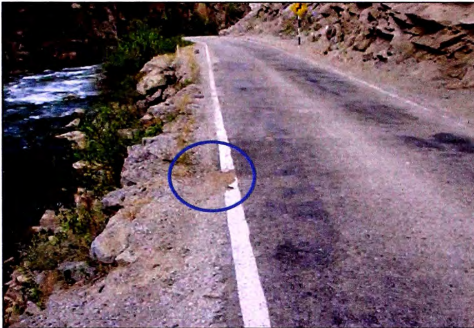
Foto N°2.2: Bache en el hombro de la vía
