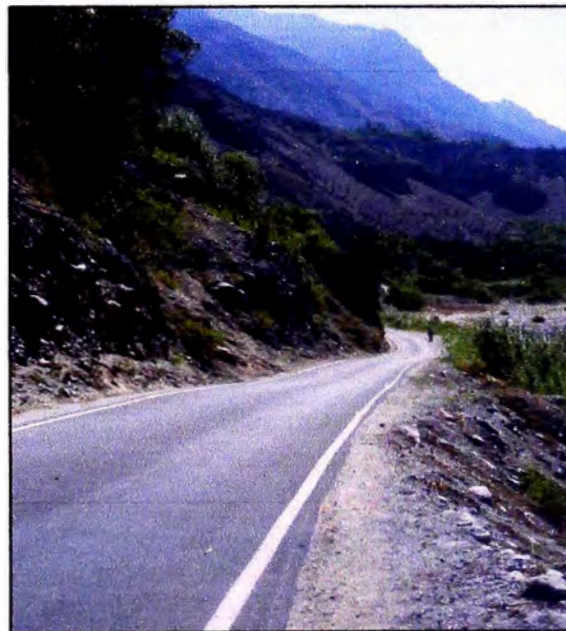
Figura N° 5.1 Irregularidad altimétrica en la vía
