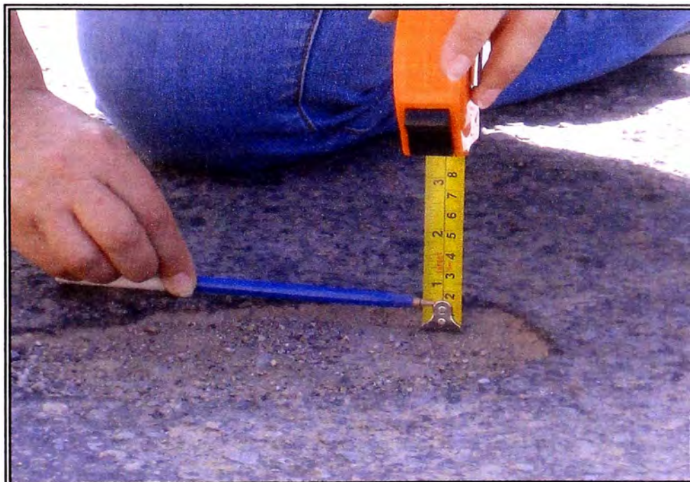
FOTO 16: Presencia de pequeños huecos DE 1.5 mm. Aproximadamente en la monocapa, entre las progresivas Km. 106+030 al Km. 106+050.
