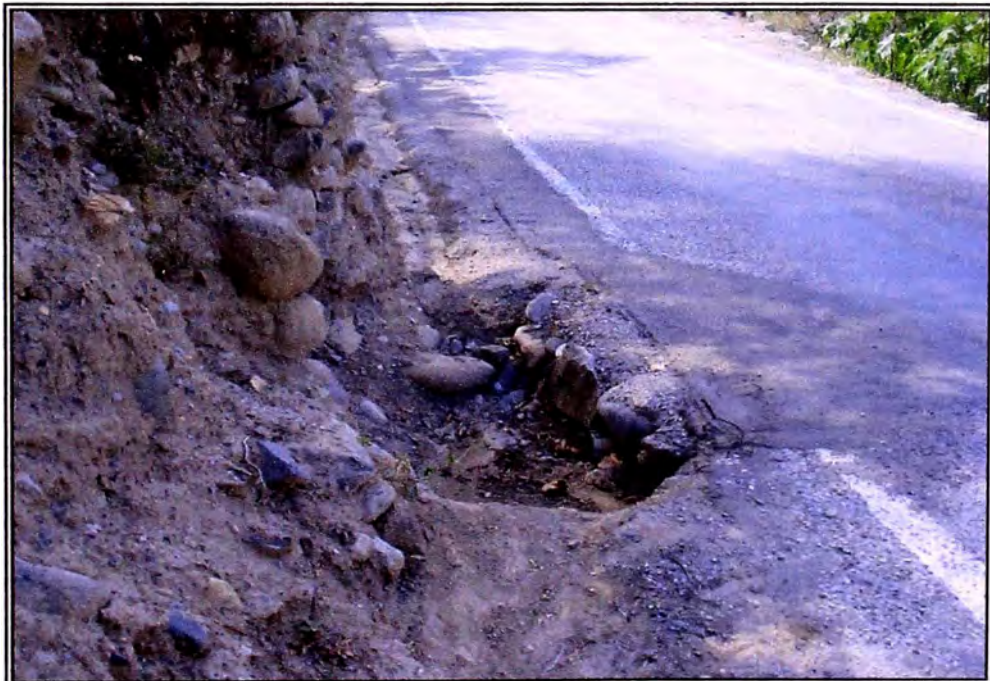
FOTO 04: Obstrucción de alcantarilla PVC, en progresiva Km. 107+690 (LI).
