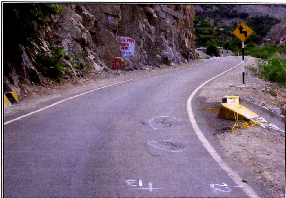
FOTO 14: Alcantarilla donde se observa escurrimiento de la carpeta en la Huella Derecha de la superficie monocapa entre las progresivas Km. 106+450 al Km. 106+460. Caia toma lado Izquierdo
