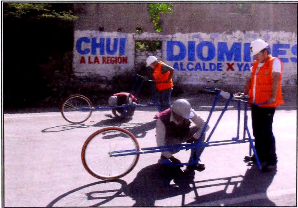
FOTO 12: Inicio de ensayo Sub Tramo 2: Km. 106+000. Lado Derecho Sub Tramo 2: Km. 106+600 al 106+200
