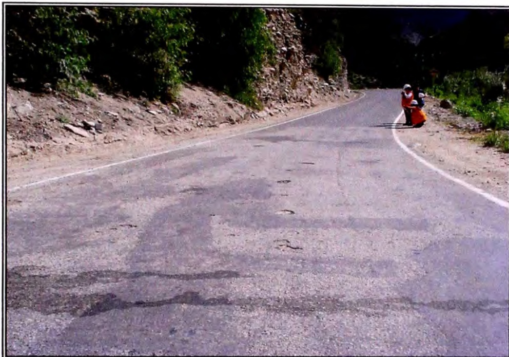
FOTO 15: Presencia de pequeños huecos en la superficie del tratamiento superficial Slurry Seal sobre Monocapa, entre las progresivas Km. 106+030 al Km. 106+050.
