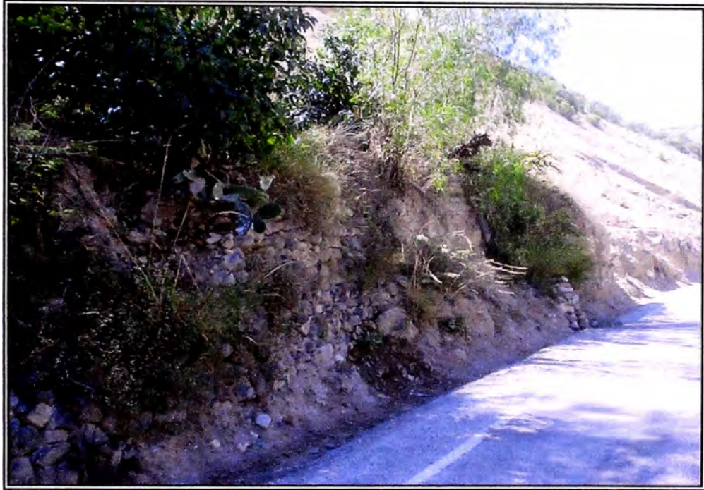
FOTO 03: Falta de drenaje del escurrimiento superficial, Km. 107+790 (LI).
