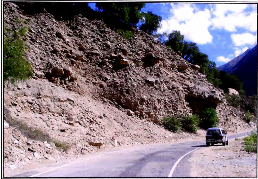
FOTO 17: Se observa zona de inestabilidad de talud, Km. 106+020 (LI).
