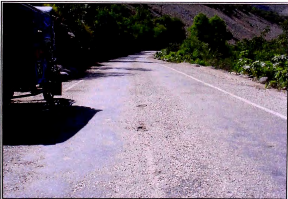
FOTO 06: Presencia de pequeños huecos en el eje de la vía, entre las progresivas Km. 107+660 al Km. 107+690.
