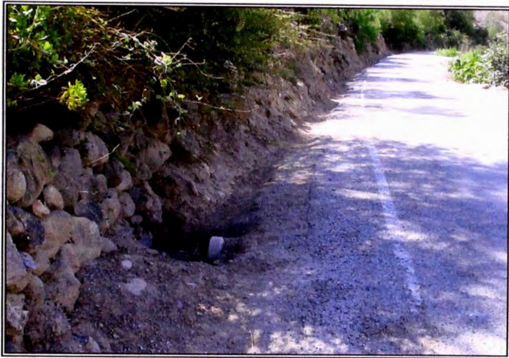
FOTO 05: Obstrucción de alcantarilla de concreto, Km. 107+680 (LI).
