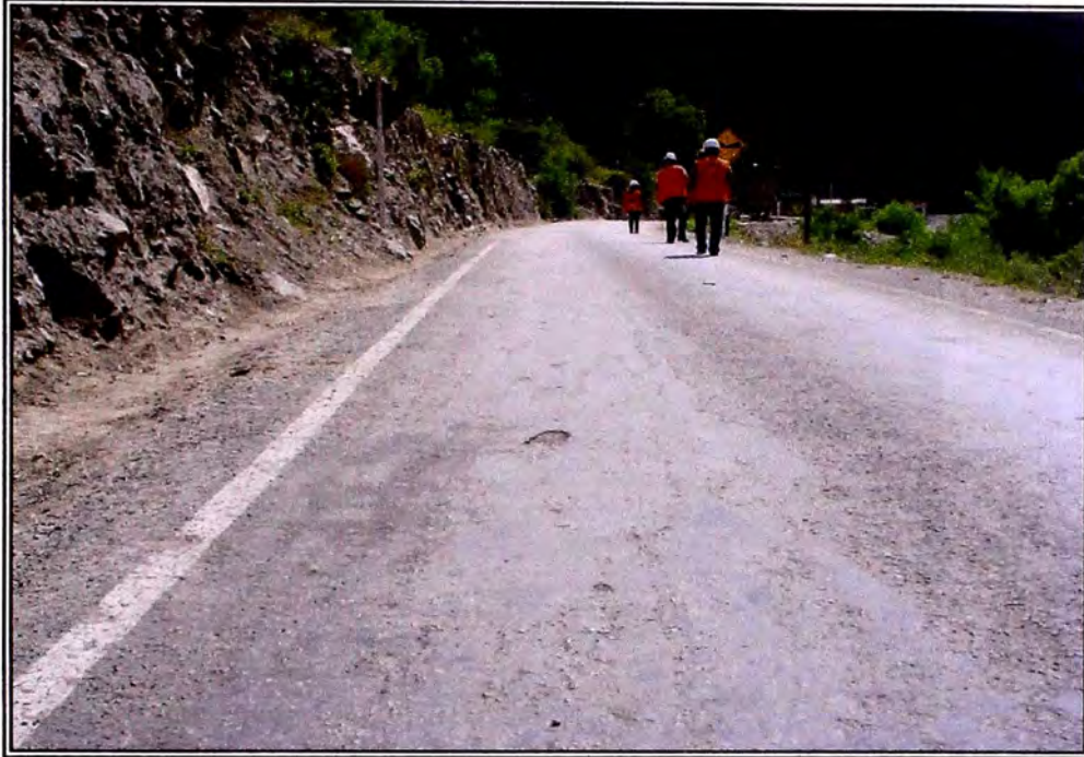
FOTO 11: Presencia de pequeños huecos en la superficie del tratamiento monocapa, entre las progresivas Km. 106+700 al Km. 106+720.
