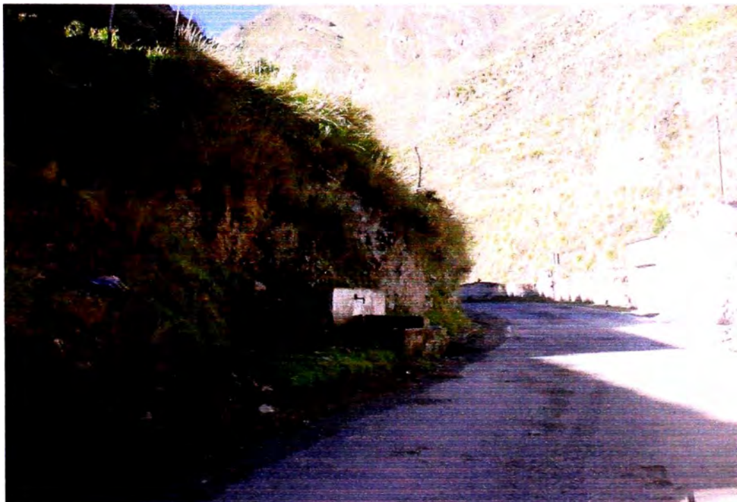
FOTO 02: Pavimento deteriorado por mal drenaje
