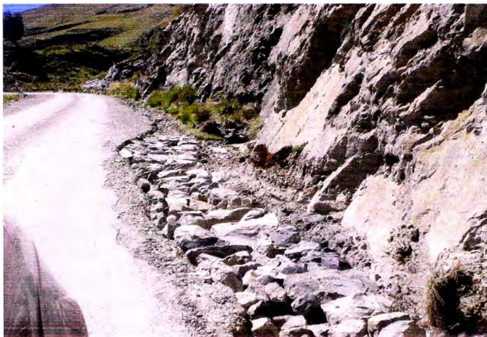
FOTO 05: Drenaje Inexistente, pavimento deteriorado, disminución ancho de la via
