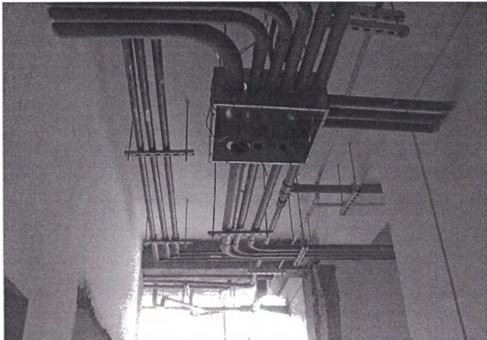
Foto N° 08 Vista de Instalaciones Eléctricas
