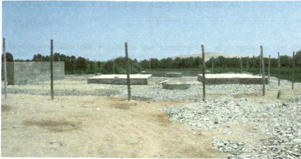
Foto N° 10: Disposición final de la Planta de Tratamiento del Centro Poblado Mazo.
