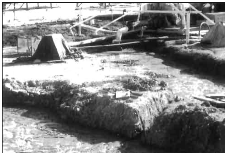
Figura 2 - 1. Diques y Tanques de Lodo en Tierra
