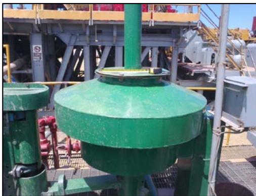
Figura 4 - 2. Degasificador Atmosférico DESARENADOR.
