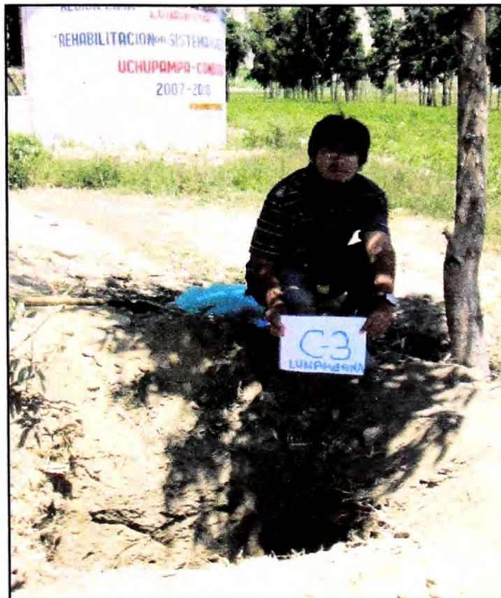
Foto N° 6: Se observa la calicata C-3, de profundidad 1.50m, para la línea de Distribución Principal; presencia de limos con presencia de material orgánico, y en el fondo se observo material de conglomerado con limos.
