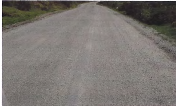
Figura N° 1.07. Tratamiento superficial con monocapa, en estado deteriorado. Cunetas de tierra y falta de limpieza.
