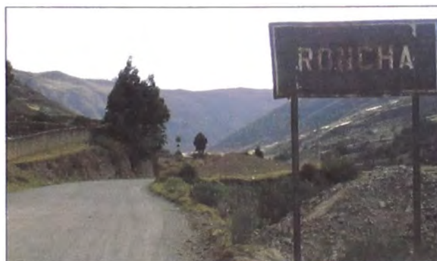
Figura N° 1.08. Orografía ondulada. Tramo con monocapa deteriorado camino hacia Chupaca. Presenta señalización y elementos de seguridad en pésimo estado.
