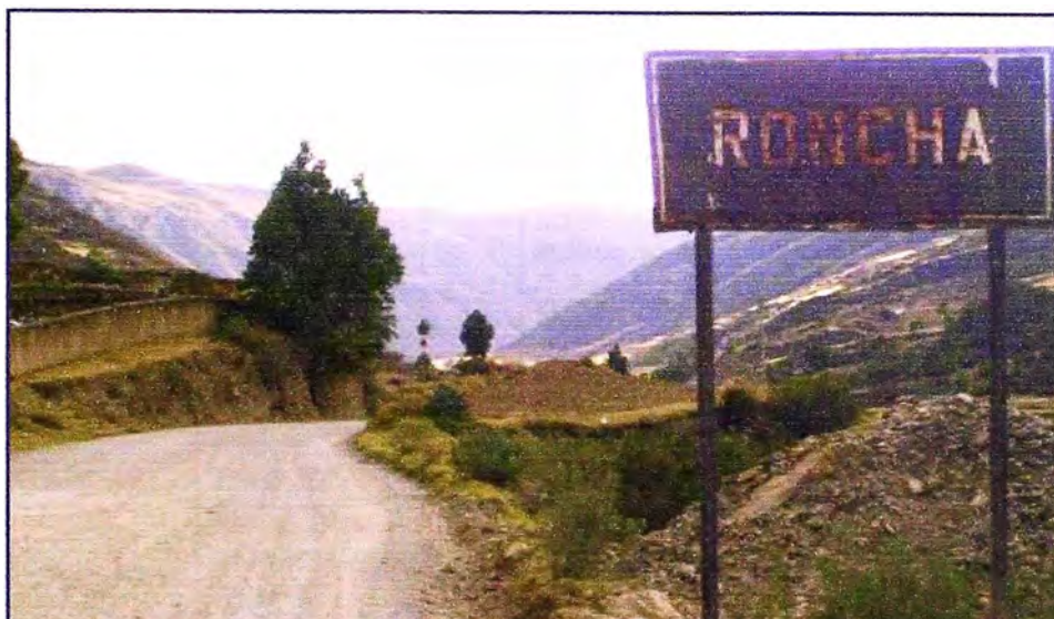
Fig. 1.05 Tratamiento superficial monocapa deteriorado cerca a Chupaca (Fuente: Propia)
