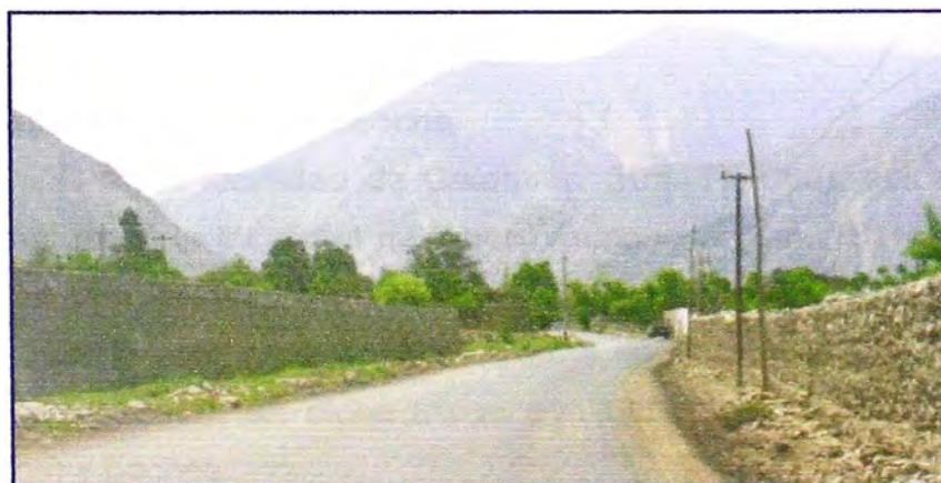
Fig. 1.01 Lunahuana-Pacarán con tratamiento superficial bicapa mas slurry seal (Fuente: Propia)
