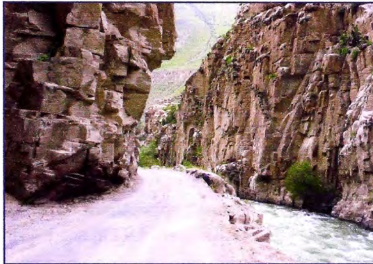
Fig. 1.02 Zona crítica sin elementos de seguridad (Fuente: Propia)
