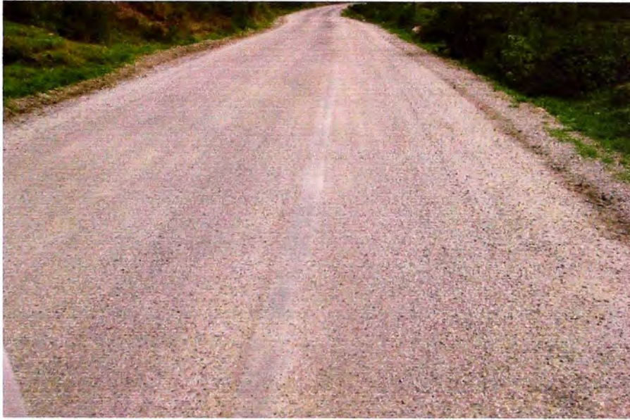
Fig. 1.04 Tratamiento superficial monocapa deteriorado (Fuente: Propia)
