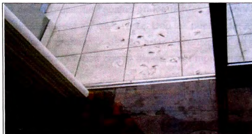
Figura 3.37: Falta de pendiente y sumidero en terraza
