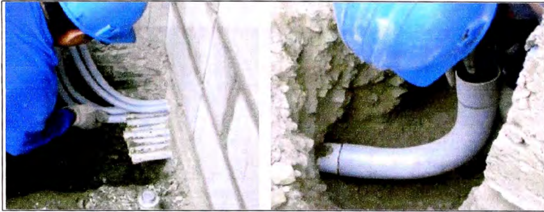
Figura 3.26: Conexión a banco de medidores
