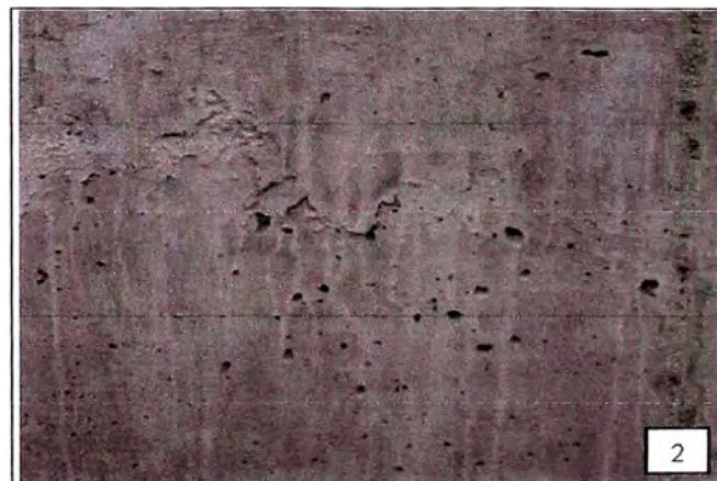
Figura 3.16: Cangrejas por desmoldante de encofrado
