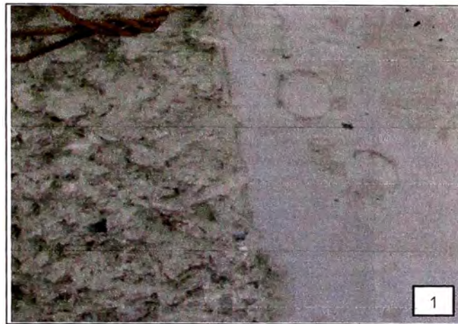
Figura 3.15: Cangrejas por mal vibrado
