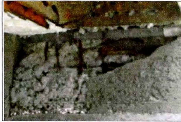
Figura 3.13: Acero de Refuerzo expuesto
