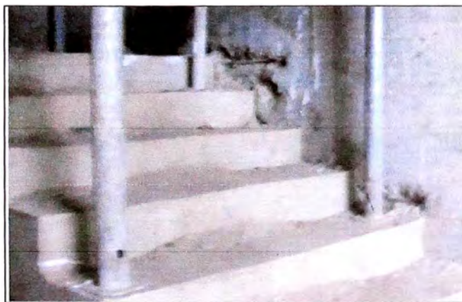
Figura 3.6: Verificación de Ancho de Escaleras
