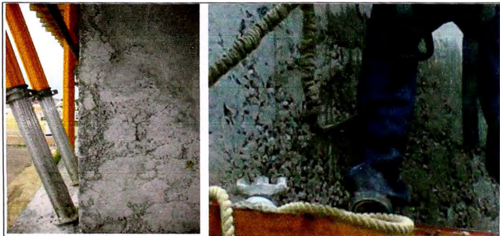
Figura 3.14: Cangrejeras por falta de vibrado
