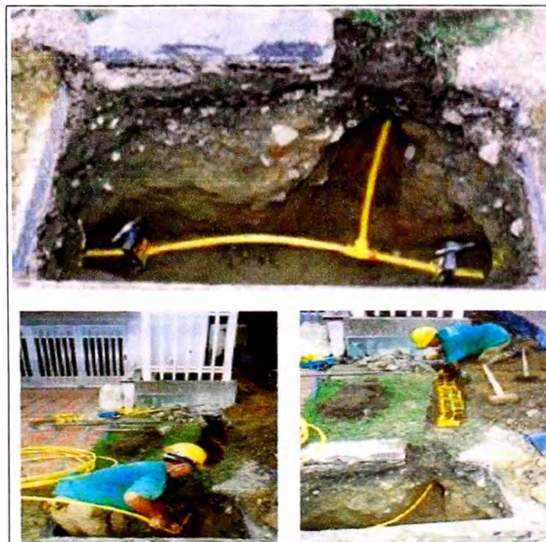
Figura 3.33: Conexiones enterradas para instalaciones de gas
