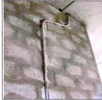
Figura 3.24: Tubería No empotrada en muro.
