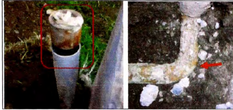
Figura 3.35: Protección de tuberías por corrosión y humedad
