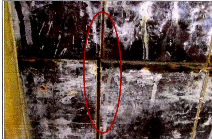
Figura 3.11: Deterioro en Encofrado Metálico
