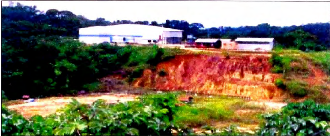
Figura 4.1. – Elevación de talud erosionado, Central eléctrica y locación
