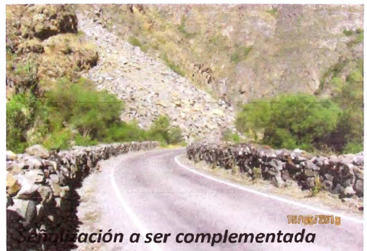
Señalización preventiva existente
