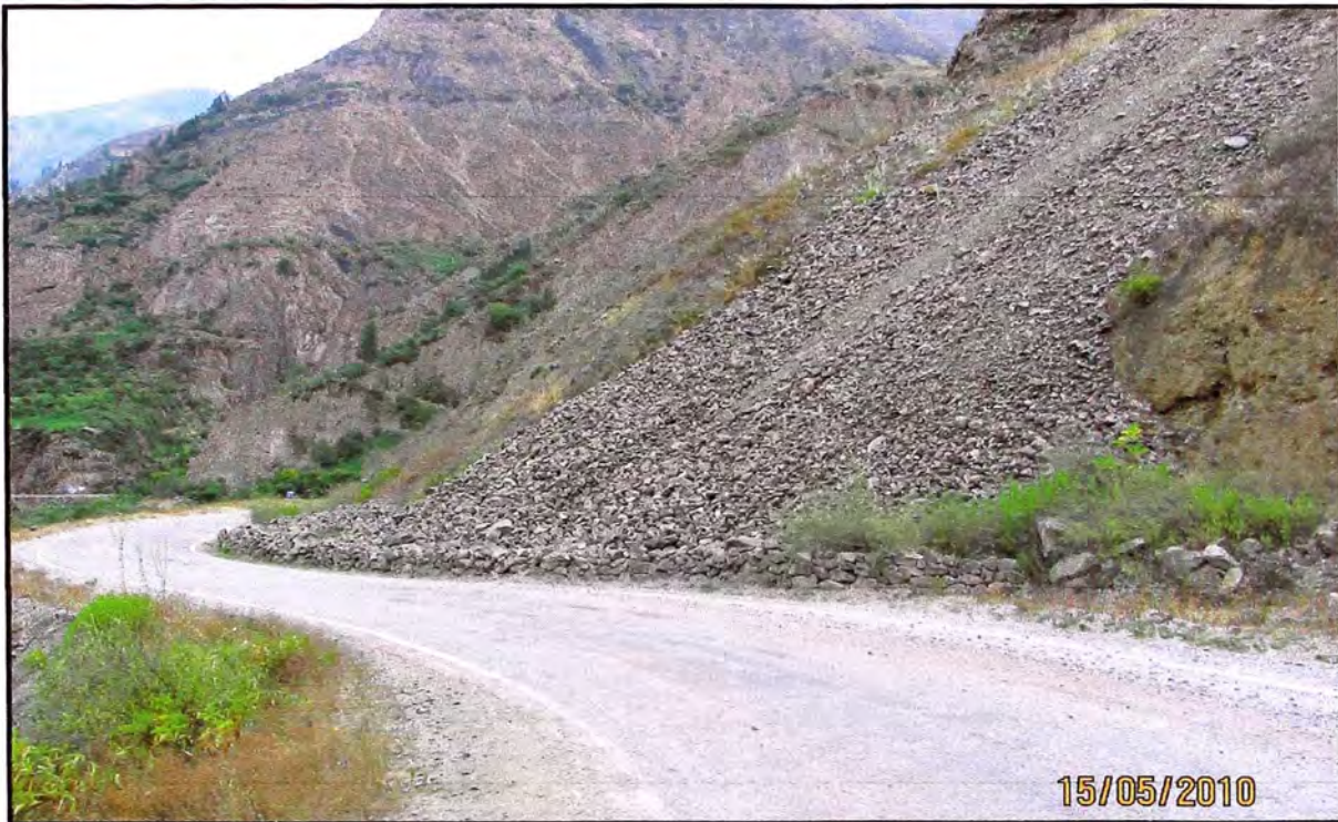
Figura N° 2.4: Deslizamiento de material rocoso suelto en el Km 134+000.
