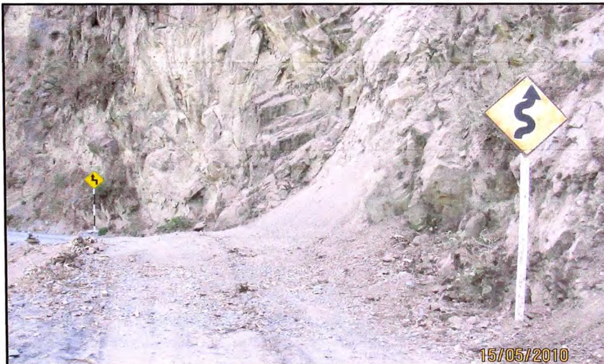
Figura N° 2.5: Deslizamiento de material desmenuzable rocoso en el Km 136+000
