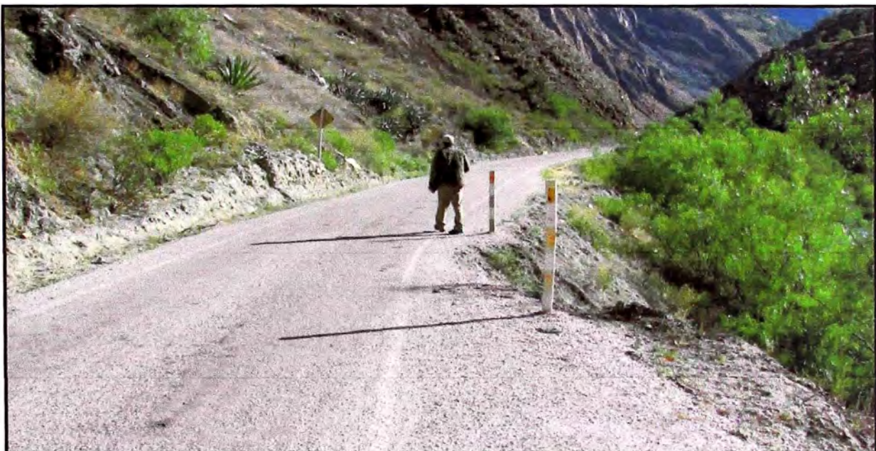
En la Figura 2.10: Se aprecia que el ancho de la vía se reduce drásticamente en el tramo señalado, durante la visita se midió 3.5 m. de ancho total.
