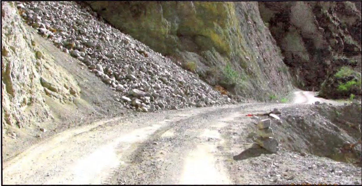
En la Figura 2.11: Se aprecia que el ancho de la vía se reduce drásticamente en el tramo señalado. durante la visita se midió 3.0 m. de ancho total.
