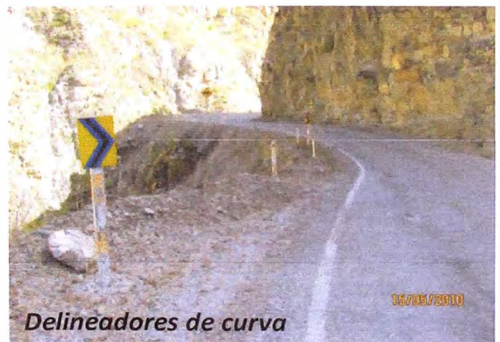
Señalización preventiva existente
