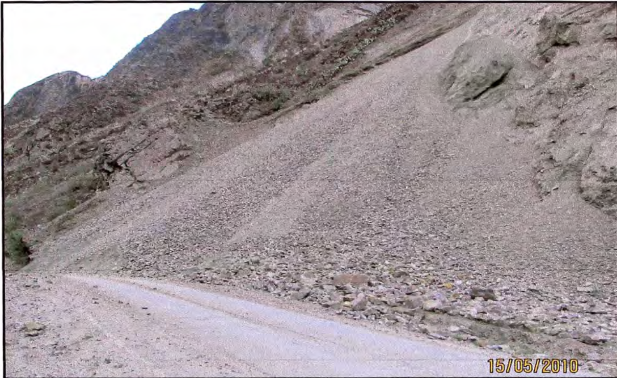
Figura N° 2.2: Deslizamiento de material granular suelto en el Km 131+000.
