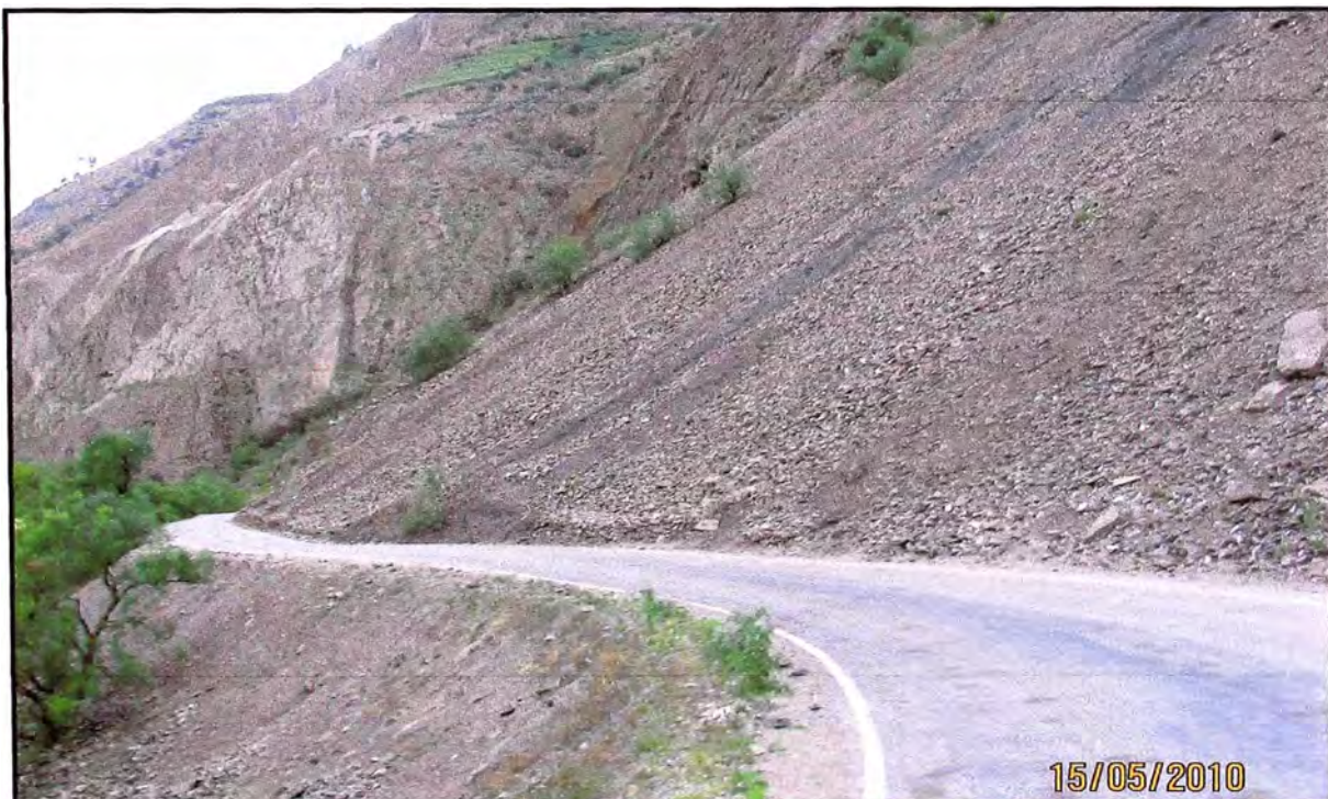
Figura N° 2.3: Deslizamiento de material granular suelto en el Km 132+000.
