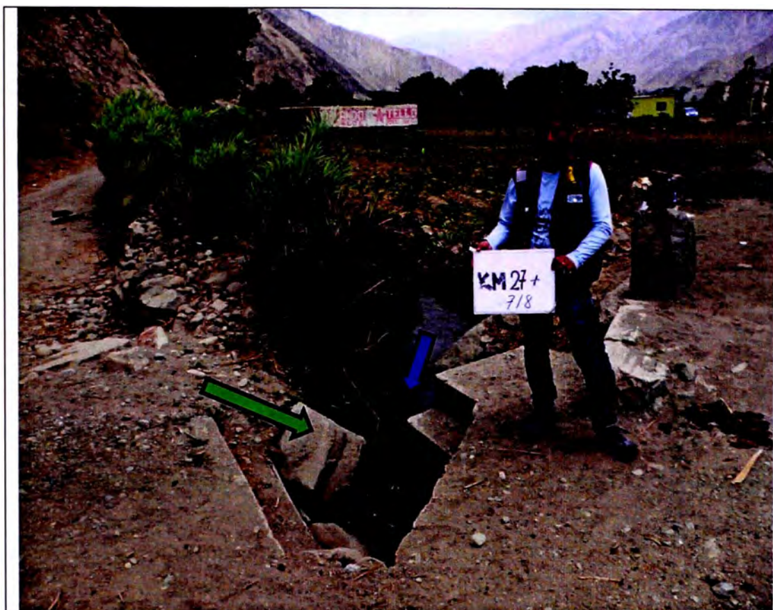
Foto N°- 3.5. Alcantarilla sobre la Progresiva 27+718. Urge una limpieza en la alcantarilla, las aguas que transporta es para riego de tierras de cultivo. La flechita azul indica la dirección del curso de agua.
