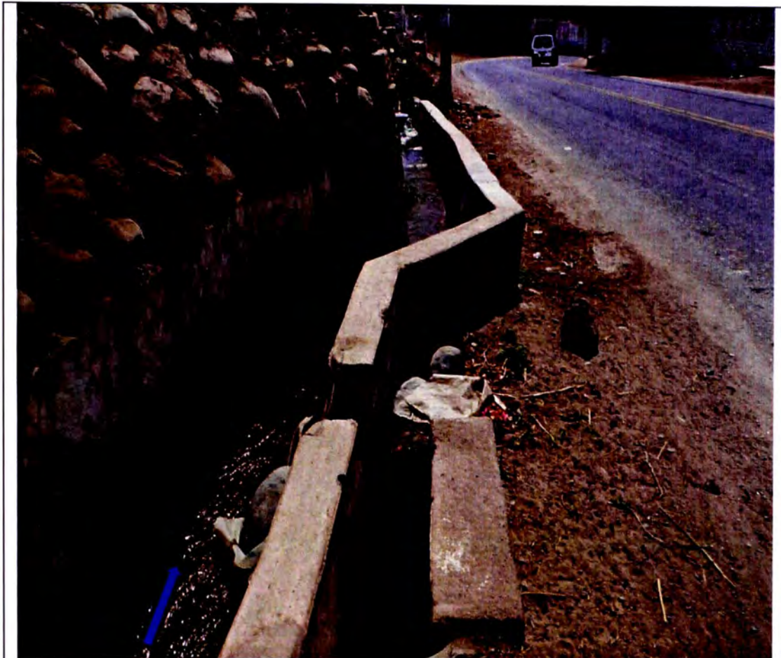
Foto N°- 3.10. Drenes Domiciliarias. Sobre la progresiva km 28+150, se muestra el drenaje específicamente para evacuación de las viviendas circundantes a la pista, entregando su descarga a las alcantarillas correspondientes; no hay cunetas proyectadas.
