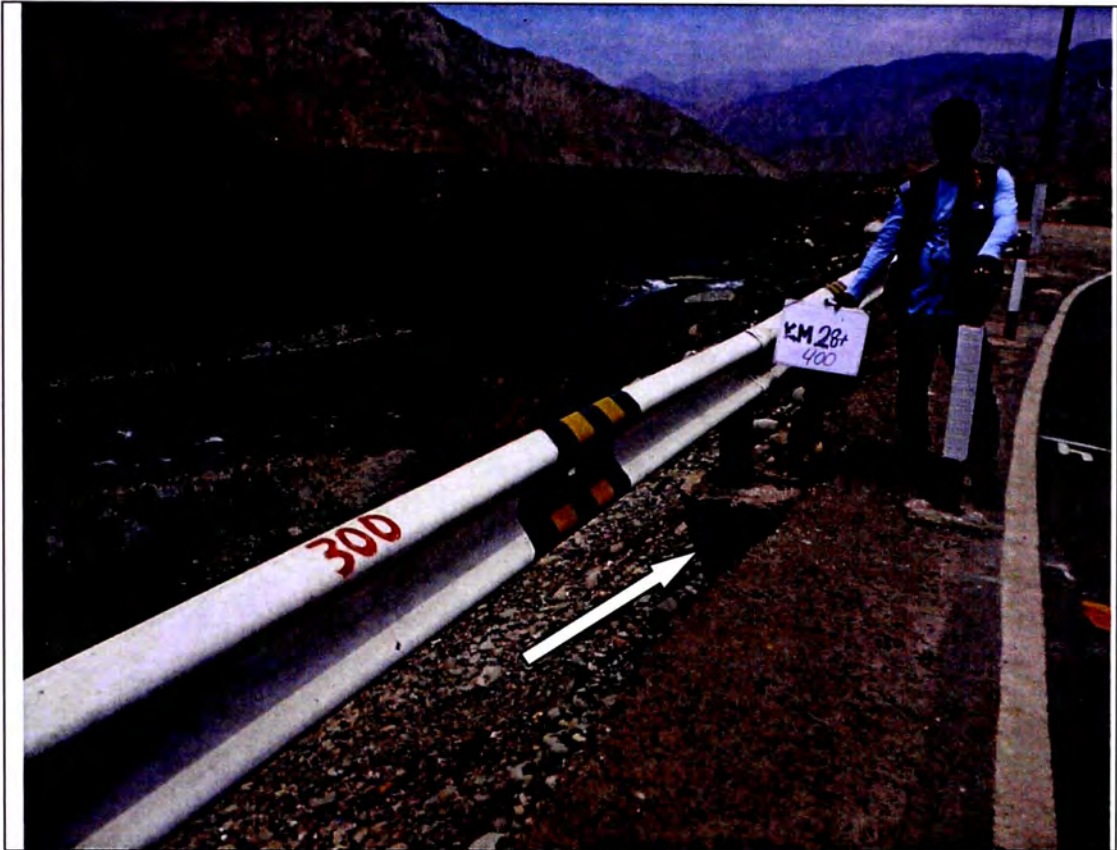
Foto N°- 2.9. Erosión en la Progresiva: 28+380. La erosión del talud ha hecho que el cimientado del poste del guarda vías, está completamente libre, cuyo peso es soportado por la solidez de los otros postes y la baranda misma.
