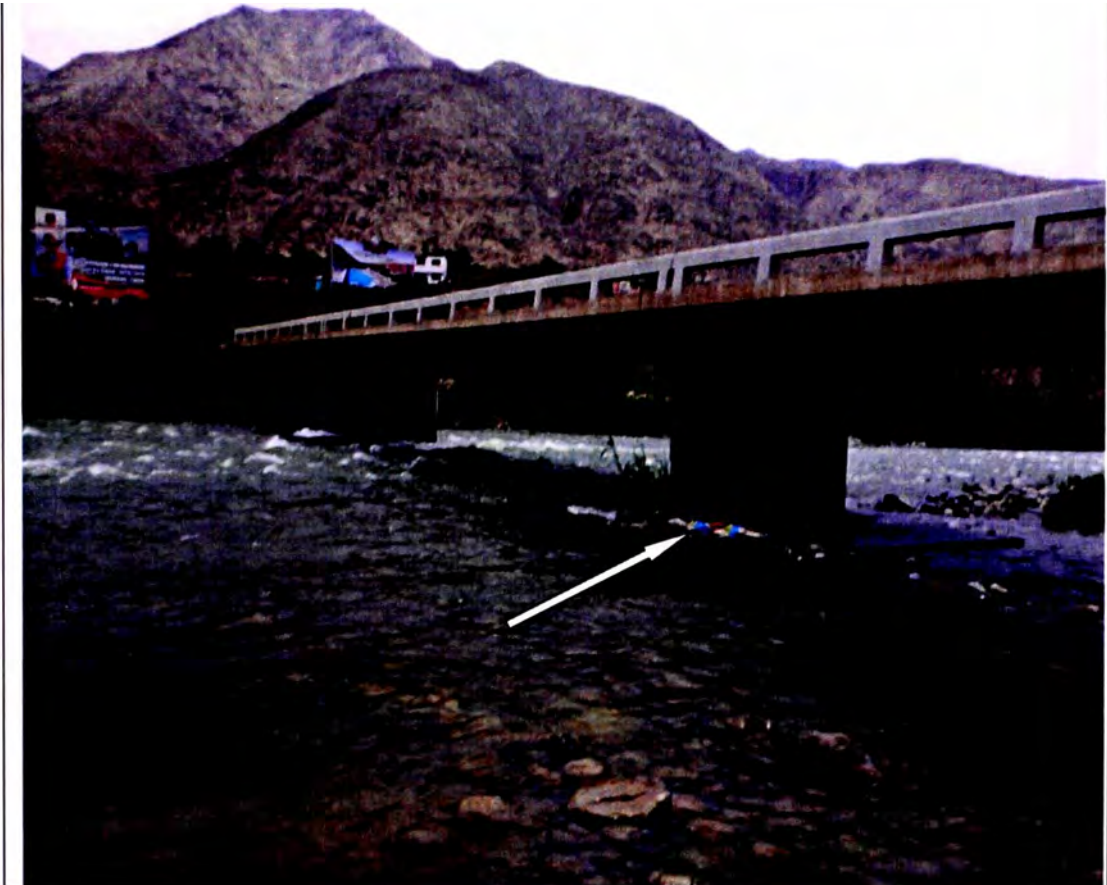
Foto N°- 2.1. Puente Sosci Progresiva km 27+800. En medio del puente Sosci, se observa la acumulación de material desechable, no hay mantenimiento adecuada de los pilares del puente, se recomienda construcción de defensas ante posible aumento de caudal en épocas de lluvias por la sierra. Véase las aguas algo cristalinas del momento. Fecha de foto 11/11/2011.
