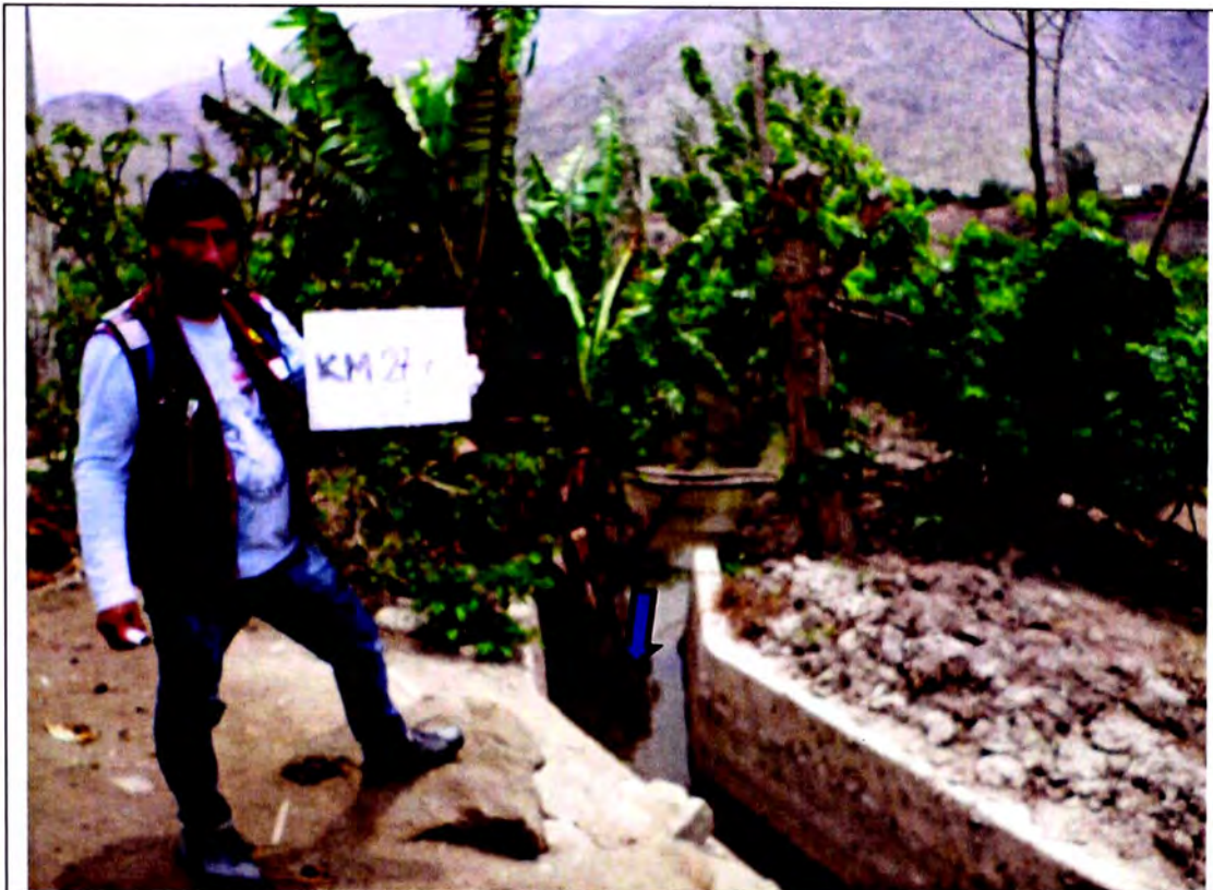
Foto N°- 3.3. Flujo sobre las Alcantarillas. En la progresiva: 27+400, como se aprecia el canal tiene buena funcionalidad, cuyas aguas pasa por las alcantarillas, pero aguas arriba necesitan limpieza. Las aguas son usadas en tierras de cultivo. La flechita indica la dirección del curso de agua.
