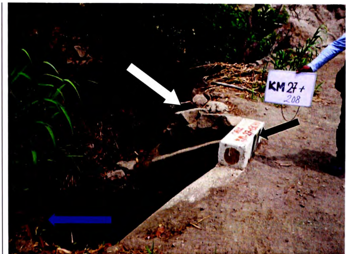
Foto N°- 3.1. Estado de conservación de la Alcantarilla. Sobre la progresiva, km 27+208. La señalización de la alcantarilla esta borrosa necesita mantenimiento. La flecha azul, indica la dirección del flujo de agua.
