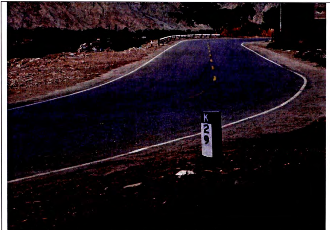
Foto Nº- 3.11. Exposición de vía. Véase el poste kilométrico de la progresiva 29+000, ambos lados de la pista asfáltica, no hay cunetas proyectadas.
