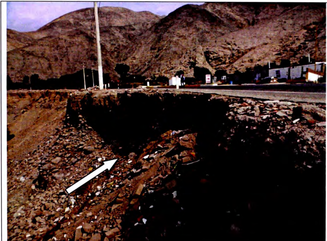
Foto Nº- 2.14. Efecto Erosivo en Progresiva: Km 28+580. Está en constante erosión el talud y afectara directamente a la plataforma de la carretera Cañete – Lunahuaná.
