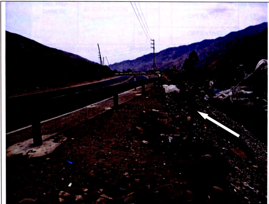
Foto N°- 2.11. Efectos sobre los Guardavías. Se observa la acumulación de desmontes y desechos orgánicos, arrojados por la población que viven cerca a la vía de tránsito.
