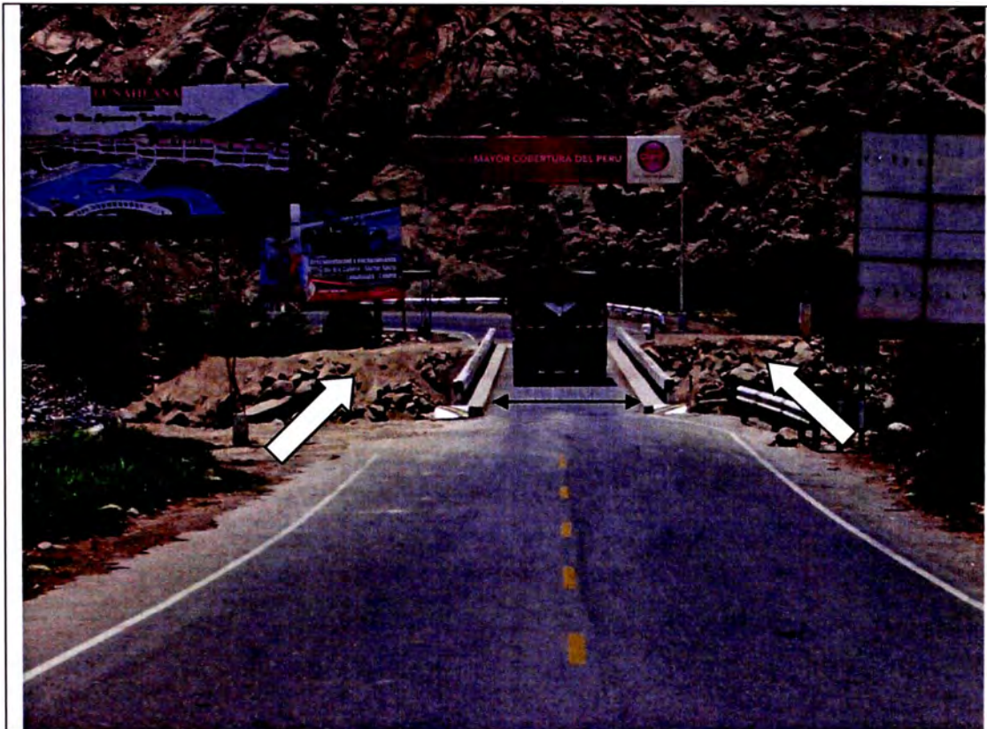
Foto N°- 2.7. Protección de Estribos. Se observa lo limitado del carril del puente para el paso de los vehículos, además frente al aumento del caudal del río Cañete, véase la protección de los estribos, con enrocados de la misma zona. Fecha de foto 18/02/2012.
