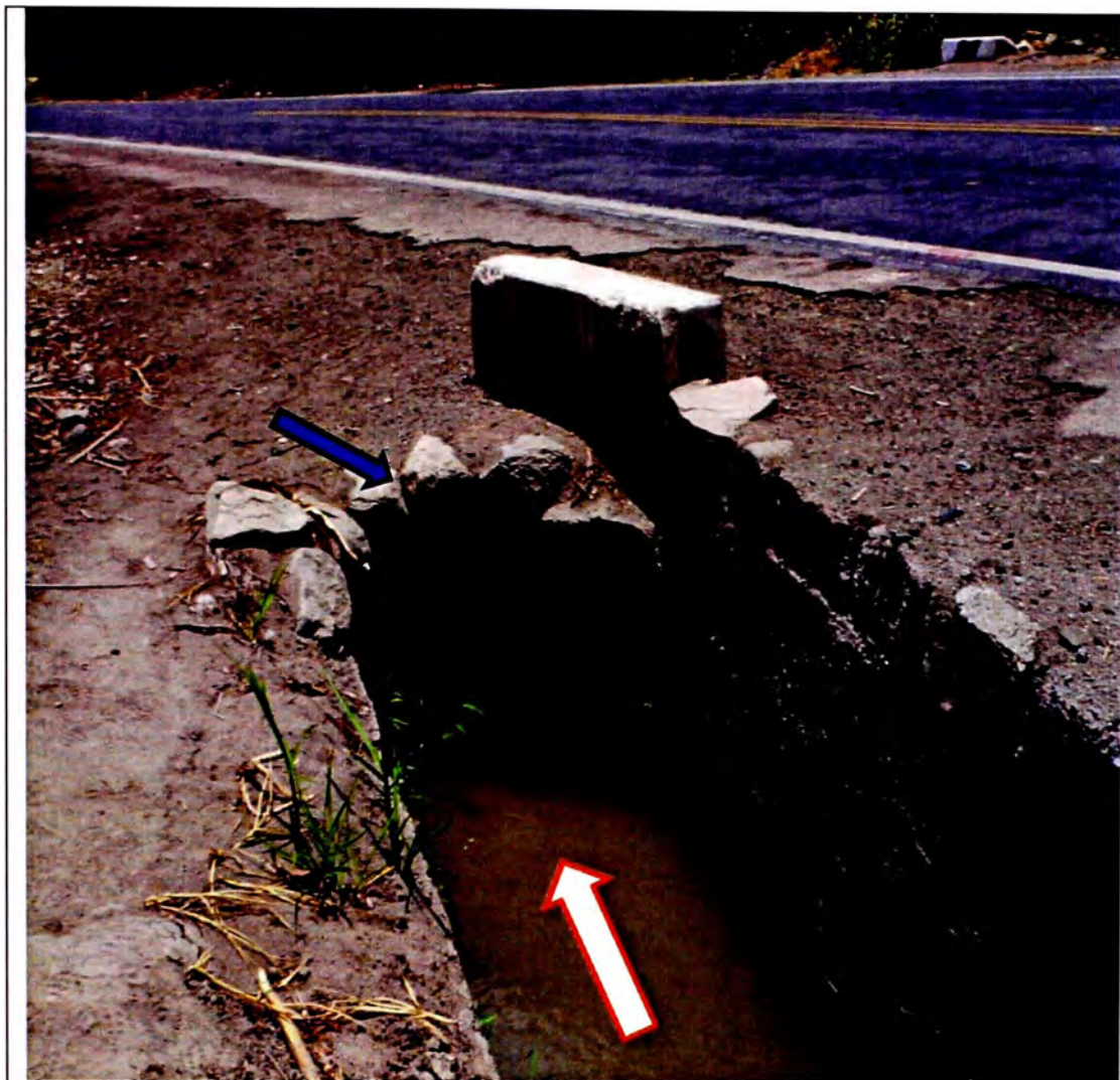
Foto N°- 3.2. Protección de Alcantarilla. Sobre la progresiva km 27+220, la alcantarilla está protegido con algunas piedras, si caen al curso de agua, seria obstrucción al flujo. La flechita blanca indica la dirección del flujo de agua.
