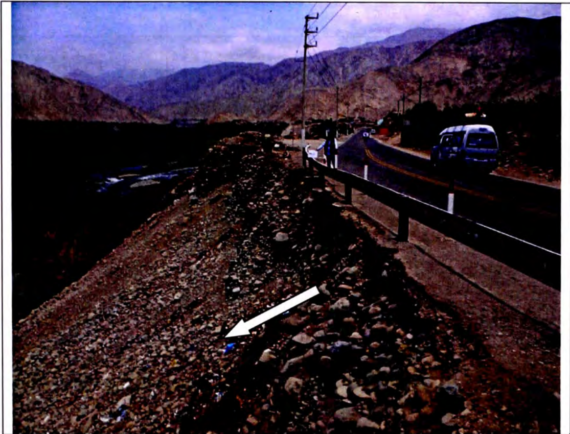
Foto N°- 2.10. Erosión Sobre el Talud. El talud está en pleno proceso de desmoronamiento afectando directamente a los postes de apoyo de los guarda vías. Posterior estará afectando a la plataforma de la vía. Se propone la construcción de muros de contención, previo estudios.
