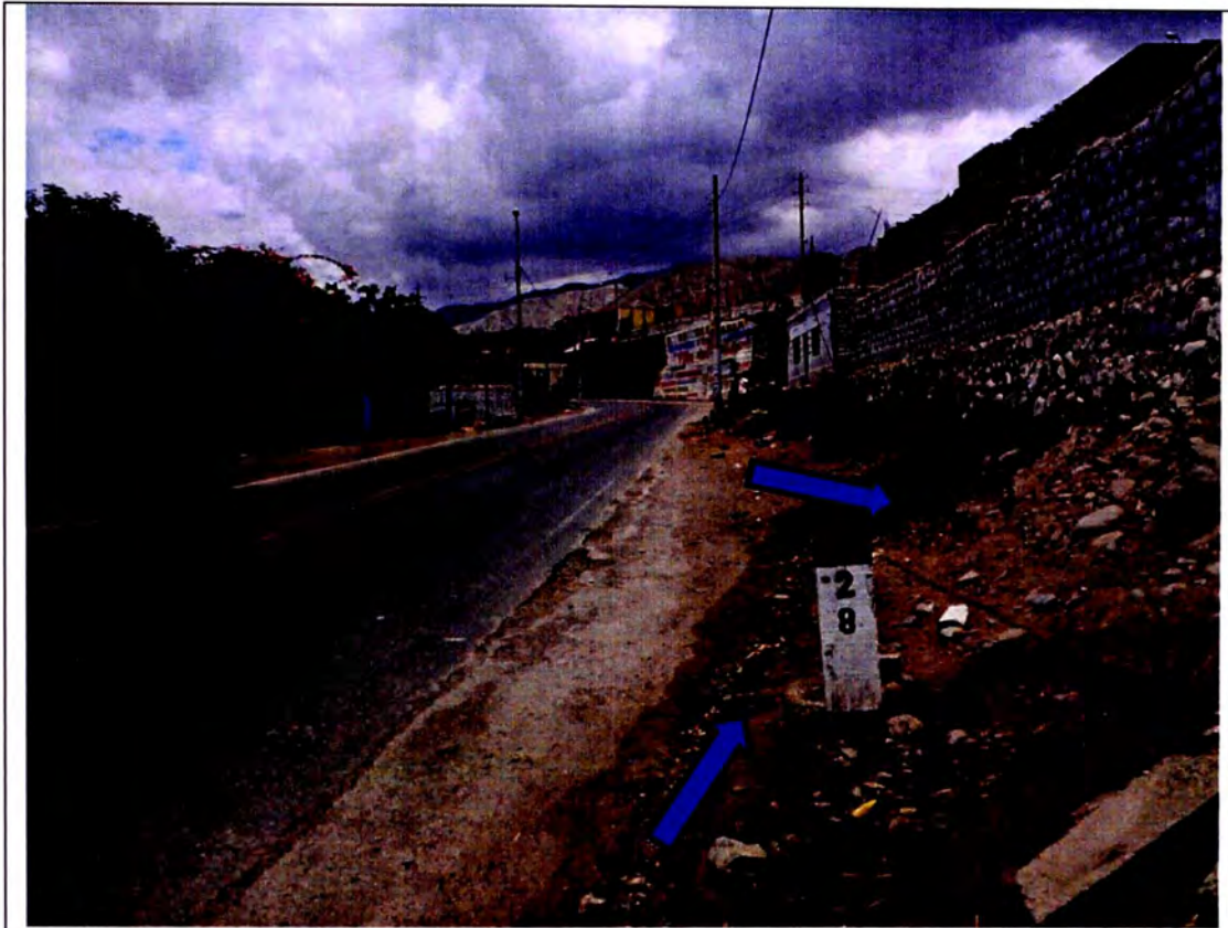
Foto N°- 3.9. Filtraciones sobre Bermas. En la progresiva km 28+000, en ambos lados de la pista no hay cunetas proyectadas. Las flechas indican muestras de humedad, producto de las filtraciones en los drenes domiciliarias.
