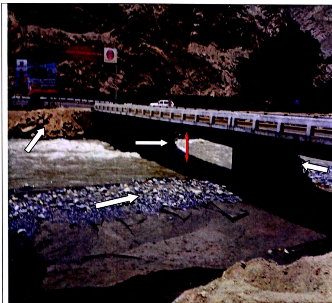
Foto N°- 2.4. Efectos Sobre el Puente Socsi. Frente al aumento del caudal del río Cañete de 250 a 300m 3 /seg aproximadamente. se ha protegido los estribos del puente; en los pilares se observa restos de material orgánico atrapados, además gran cantidad de acumulación de material de canto rodado. Se necesita la descolmatación y encausamiento el río Cañete; véase también la altura entre el nivel de agua y la superficie inferior de la plataforma del puente, no cumple con las condiciones reglamentarias, está por debajo de la altura mínima de 3m. reglamentarios. Fecha de foto 18/02/2012.
