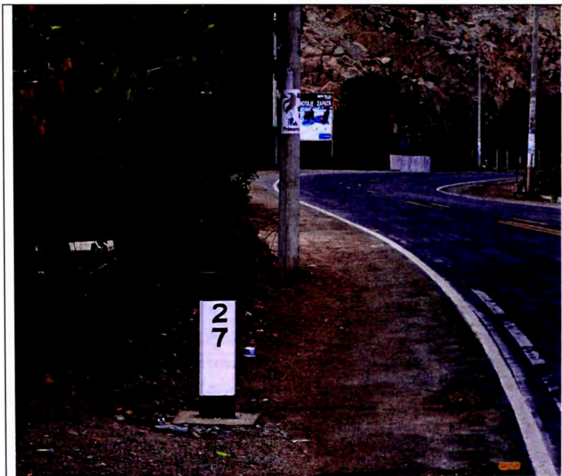
Foto N°- 3.6. Cunetas Sobre la Vía. Progresiva 27+000, se muestra que no hay cunetas proyectadas.
