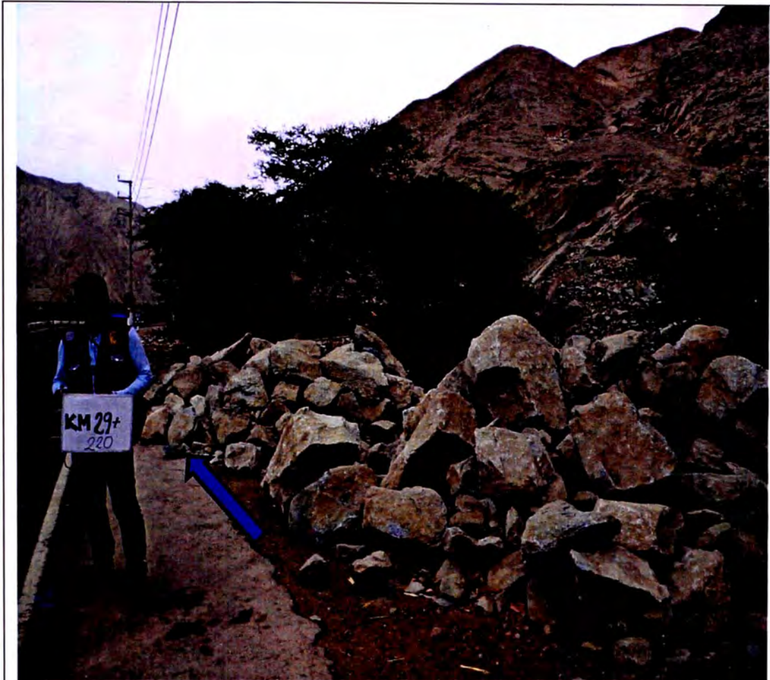
Foto N°- 4.3. Efecto negativo sobre la vía. En la progresiva, km 29+000. Los bloques de roca, están colocados sobre la berma de la vía de tránsito vehicular.
