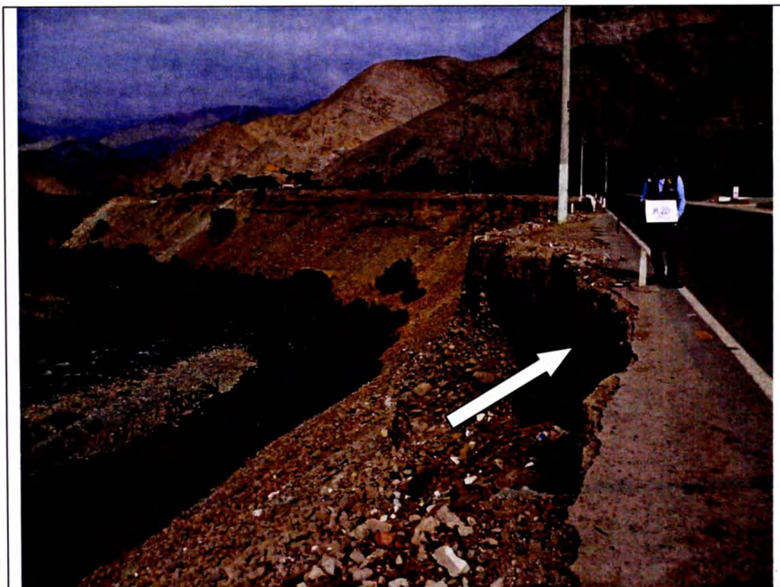
Foto N°- 2.13. Efectos sobre la Progresiva: km 28+487. La erosión del talud, afectara a la vía; se necesita pronto medidas de reemplazo, se propone construcción de muros según estudios.
