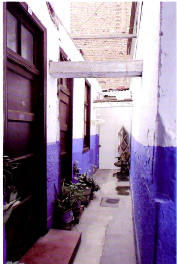
Figura 8. Improvisados refuerzos estructurales.
