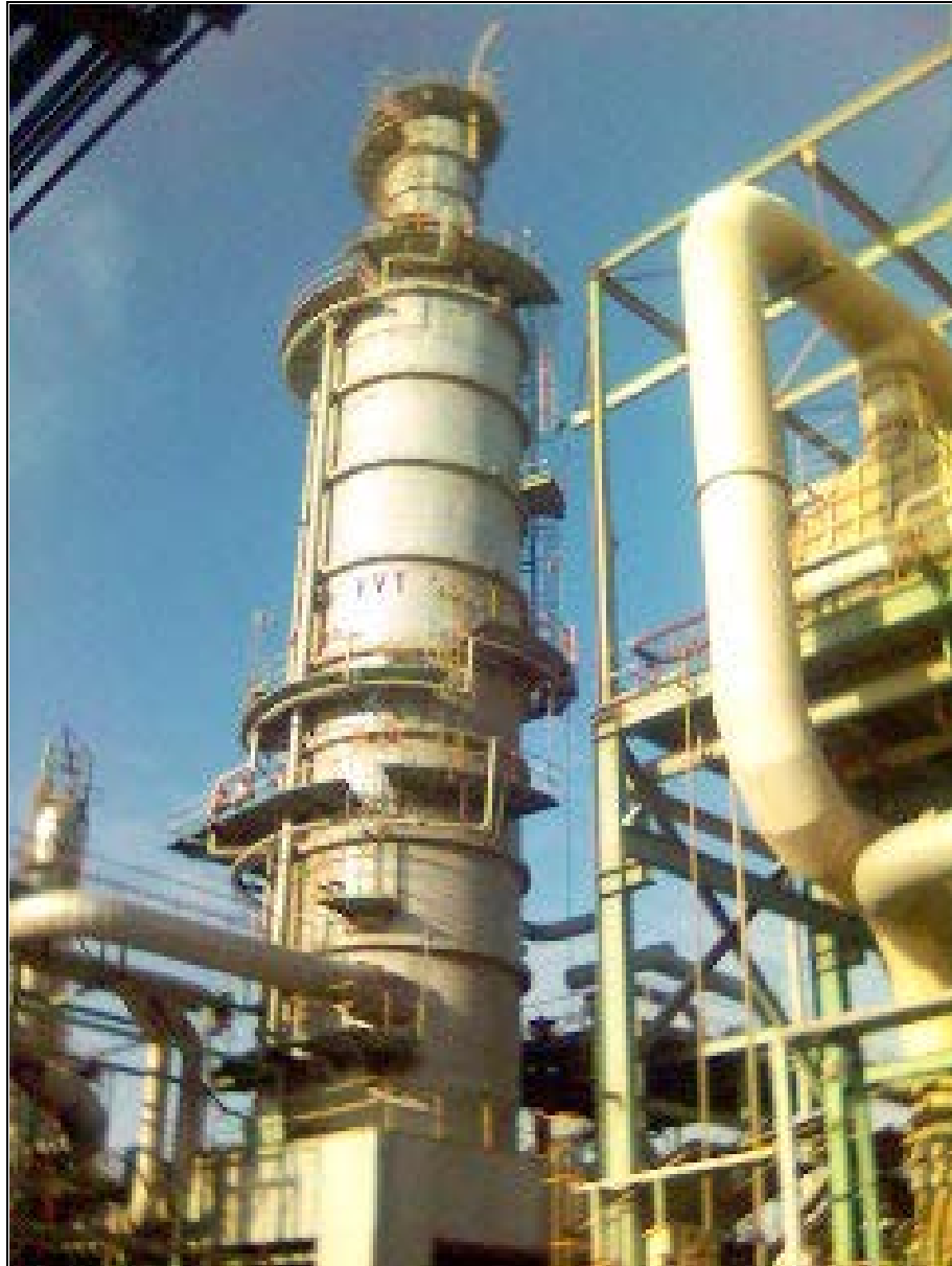
Figura 4: Columna de destilación al vacío Refinería Talara.
