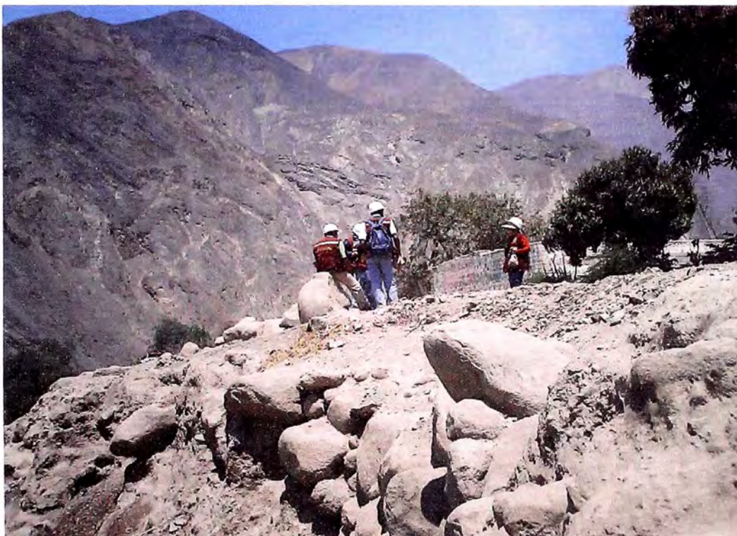
FOTO 05: PERSONAL DE TRABAJO EN PLENA CARRETERA CAÑETE-YAUYOS, SE OBSERVA EL ESTADO EN QUE SE ENCUENTRA EL MURO DE PROTECCION PARA LA VIA TOTALMENTE EROSIONADO, AL FRENTE ESTA UN MURO DE ADOBE QUE ES PARTE DE LA EXPROPIACION
